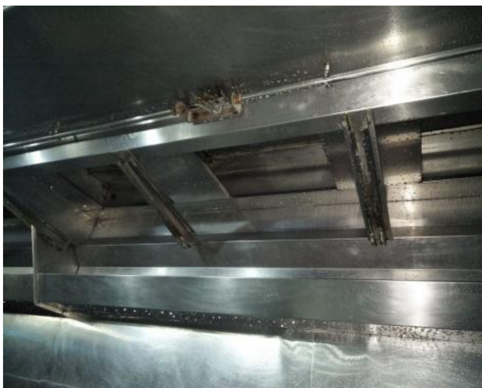
中厨房烟罩清洗后
