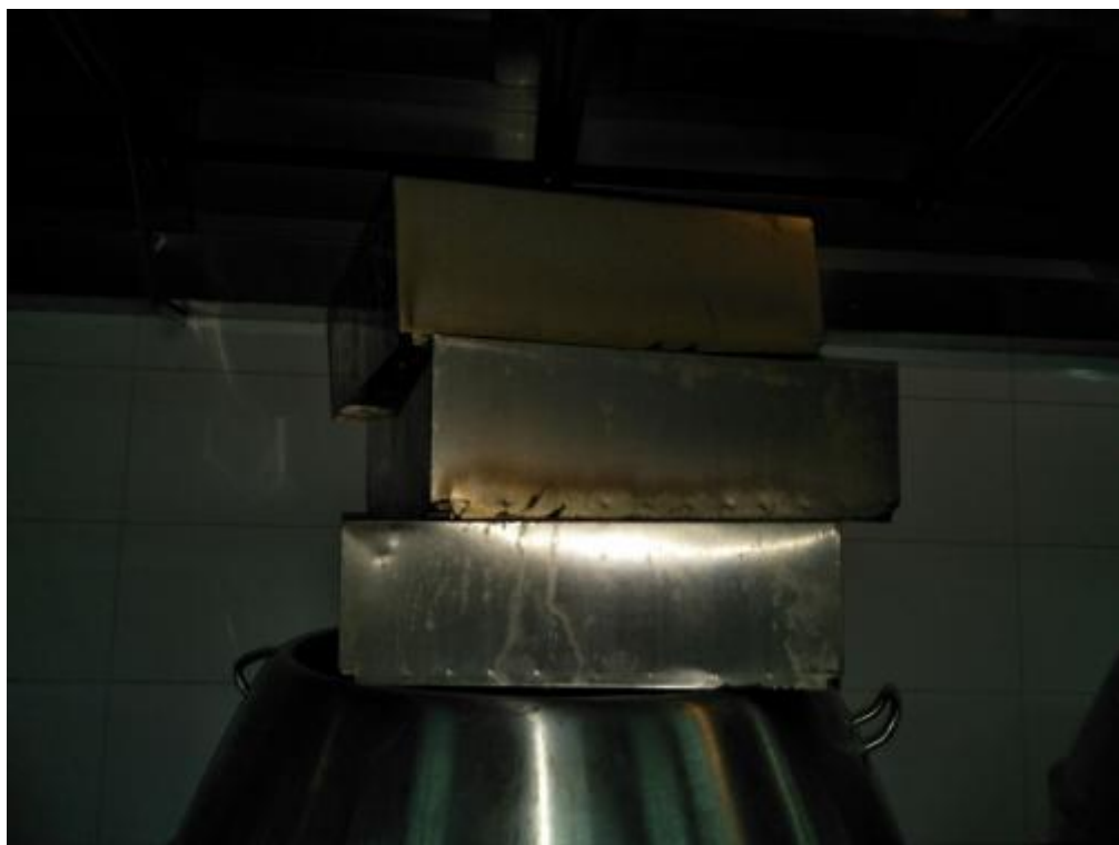
烧腊房运水风扇清洗前
