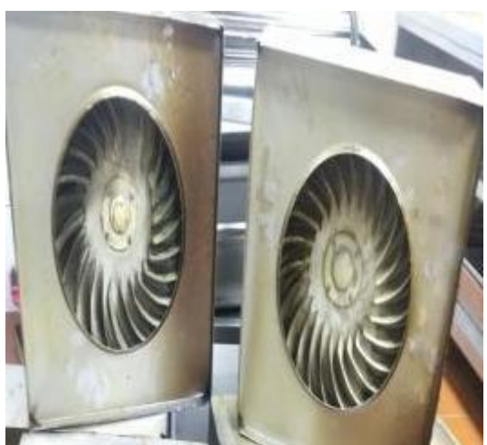
西厨房风扇清洗前
