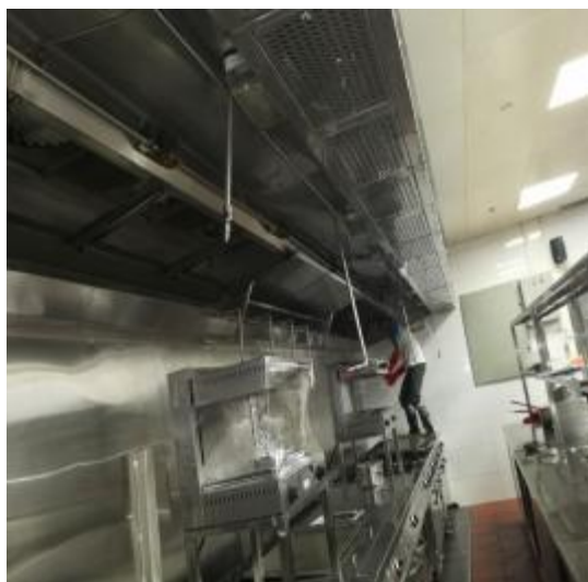
西厨房烟罩清洗中
