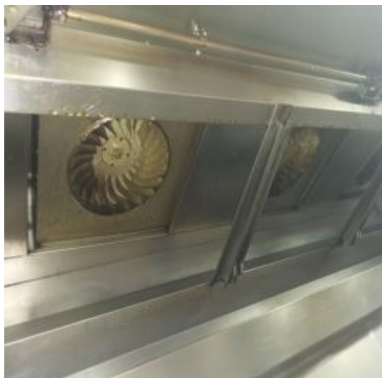
西厨房烟罩清洗前
