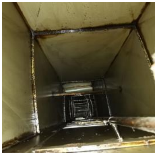
西厨房管道清洗前
