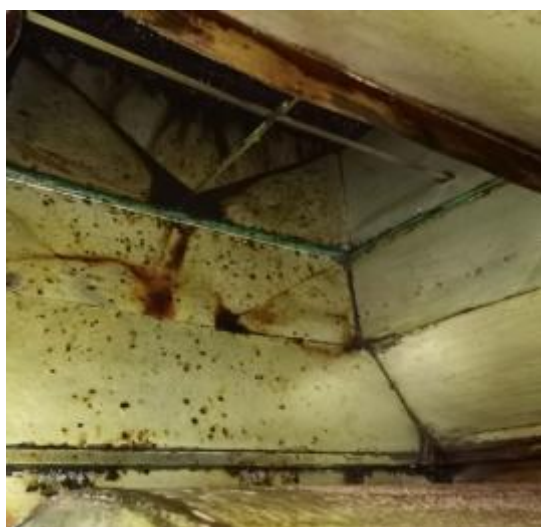
员工厨房管道清洗前
