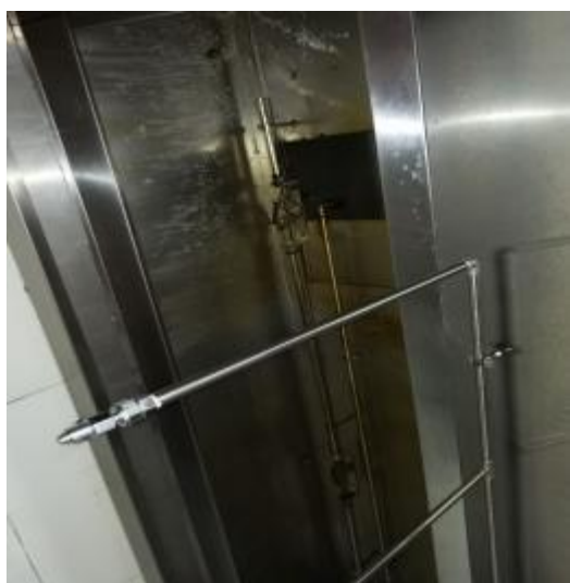
中厨房烟罩清洗前
