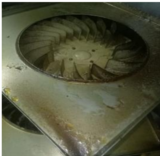
员工厨房风扇清洗前
