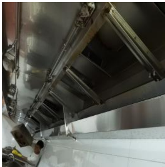
中厨房烟罩清洗中
