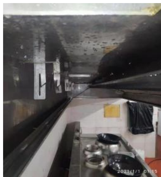
中厨房烟罩清洗后
