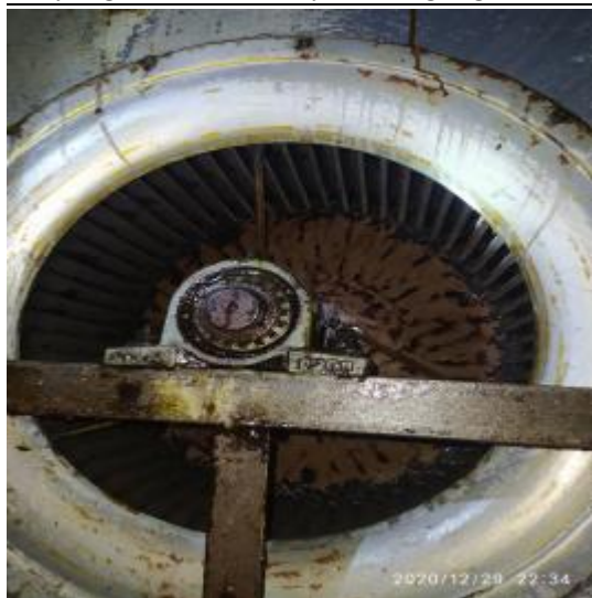
西厨房风机清洗前
