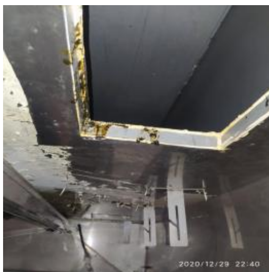
西厨房烟罩清洗前
