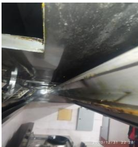
中厨房烟罩清洗前
