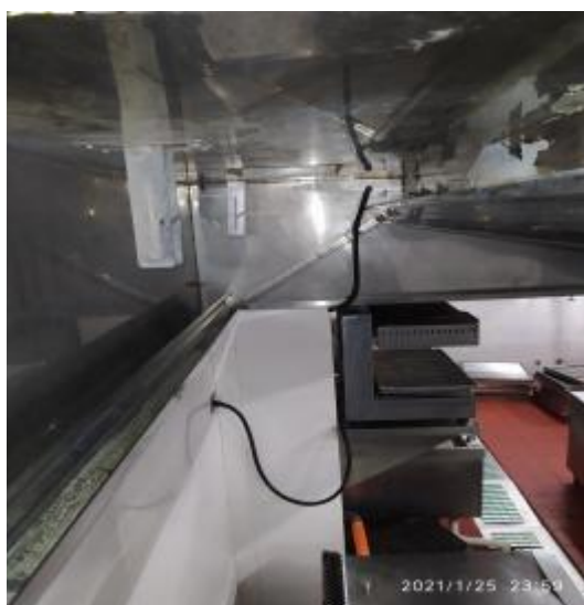
西厨房烟罩清洗前
