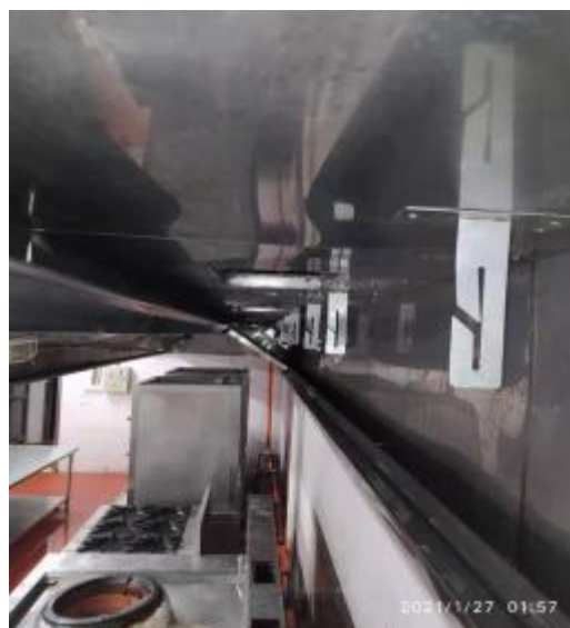
中厨房烟罩清洗后
