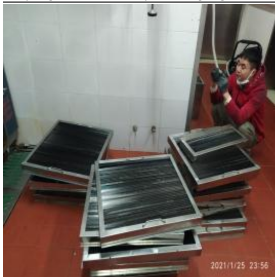
西厨房防火板清洗前
