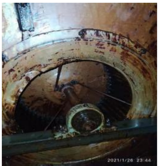
中厨房风机清洗前
