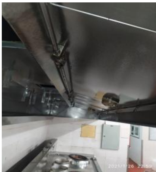
中厨房烟罩清洗前
