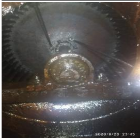
员工厨房风机清洗前
