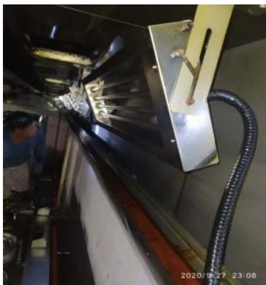
中厨房烟罩清洗前
