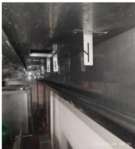
中厨房烟罩清洗后
