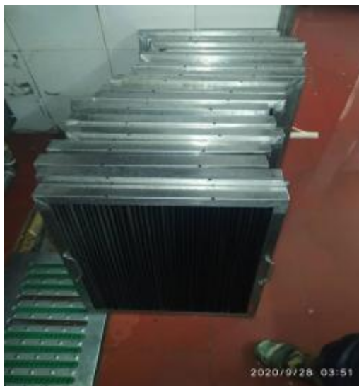
中厨房防火板清洗后
