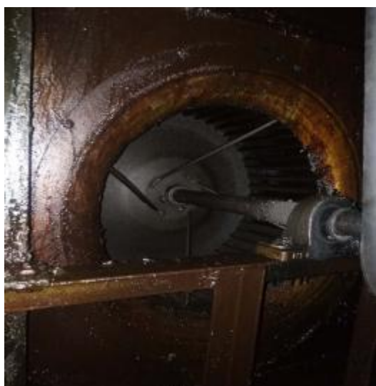
中厨房风机清洗前
