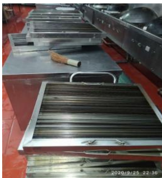
防火板清洗后
