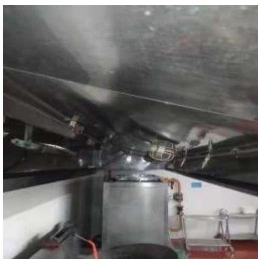
中厨房烟罩清洗后
