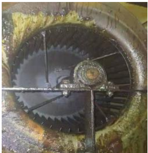
中厨房风机清洗前
