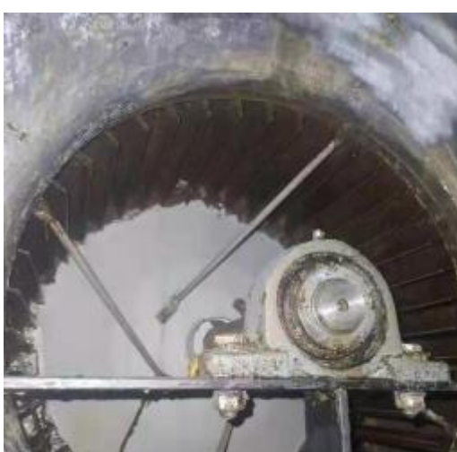
西厨风机清洗后
