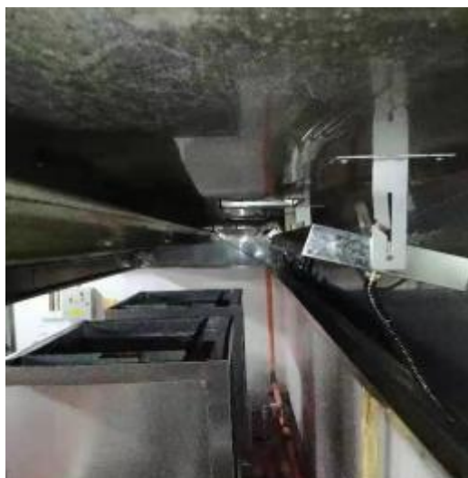
西厨房烟罩清洗前
