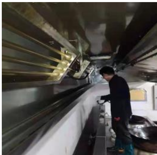
中厨房烟罩清洗中
