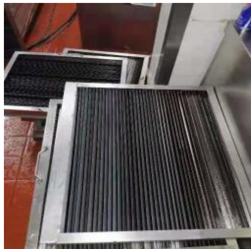
中厨房防火板清洗后
