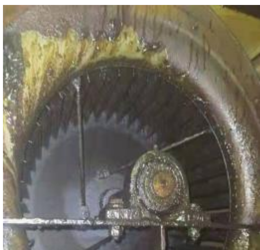
西厨风机清洗前
