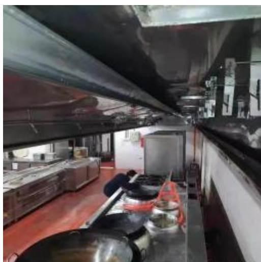
中厨房烟罩清洗前
