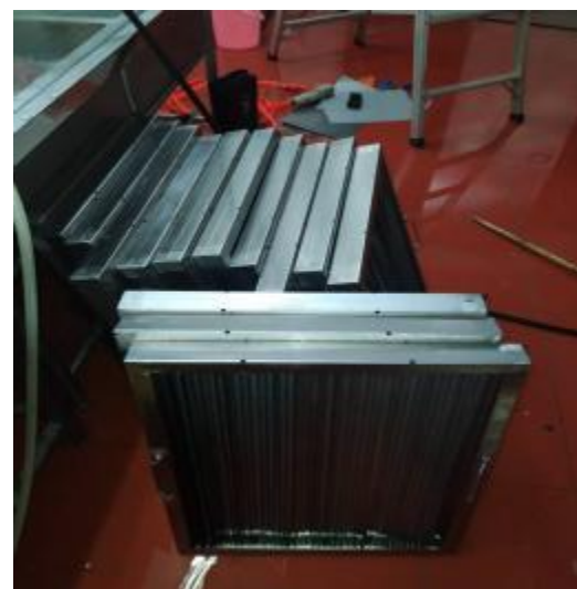
员工厨房防火板清洗后
