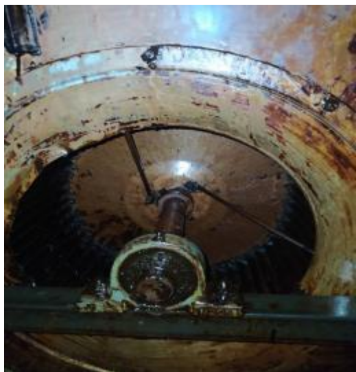
中厨房风机清洗前
