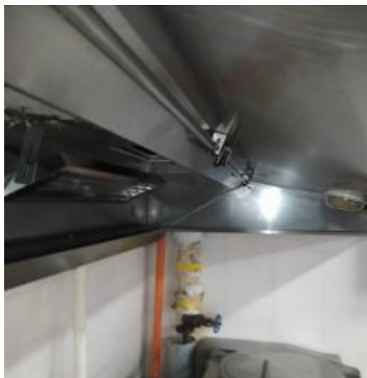
西厨房烟罩清洗前
