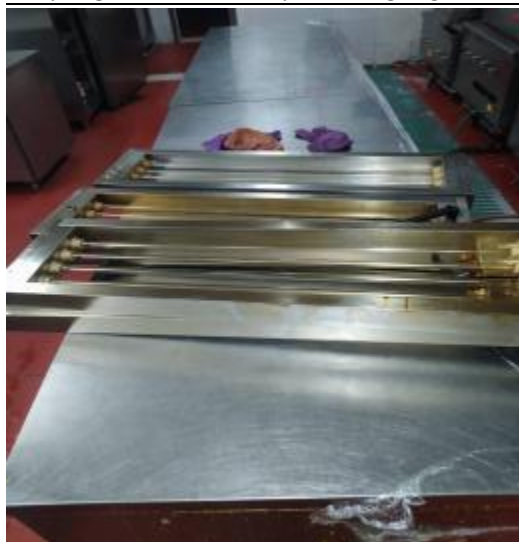
中厨房灯管清洗前
