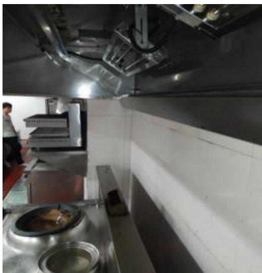
西厨房烟罩清洗中
