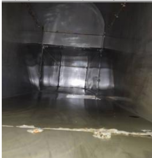
员工厨房管道清洗前
