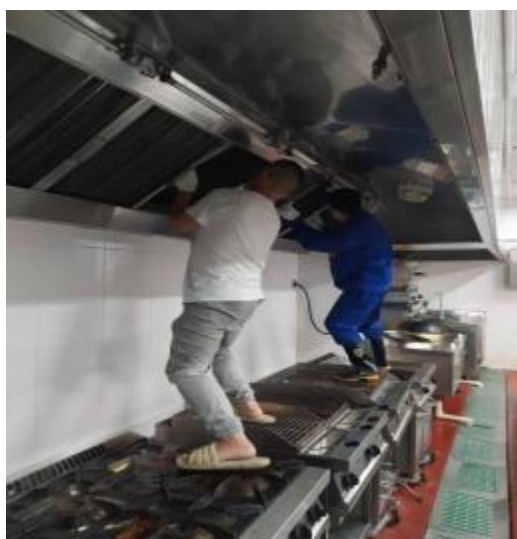
西厨房烟罩清洗中
