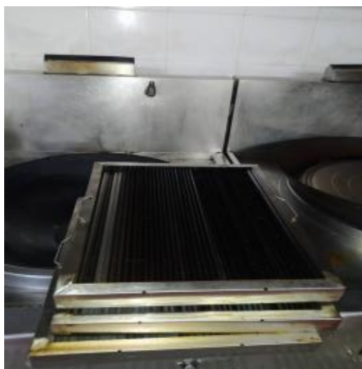
员工厨房防火板清洗前
