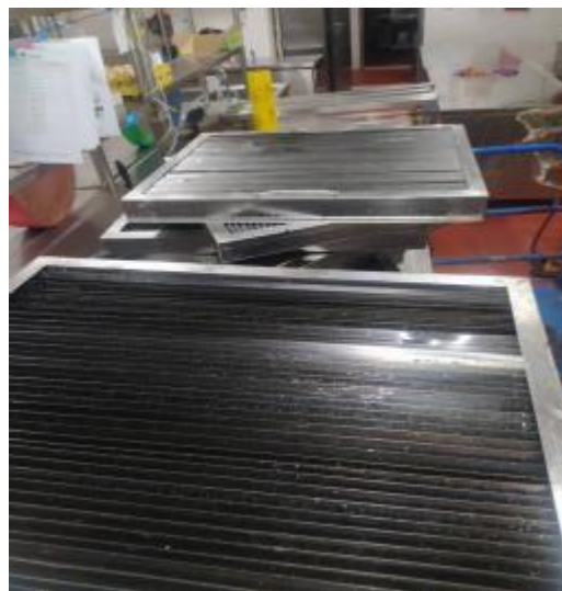
中厨房防火板清洗后
