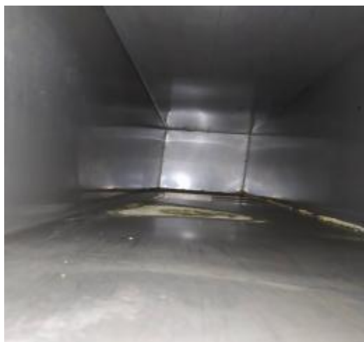
西厨房管道清洗前
