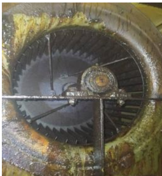
员工厨房风机清洗前
