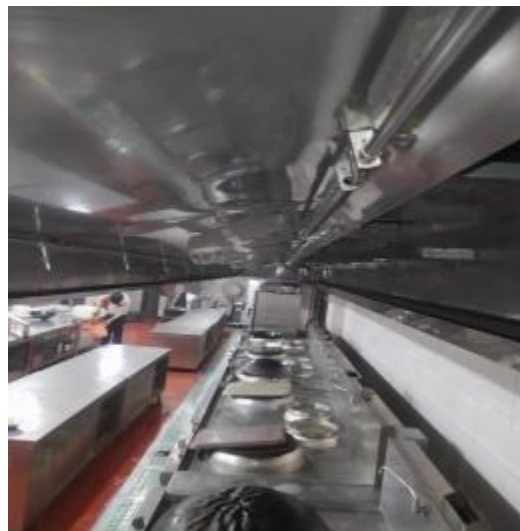
宴会厨房烟罩清洗后
