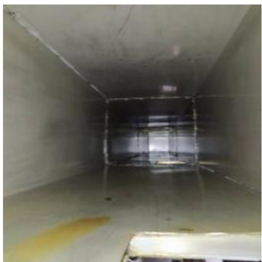
中厨房管道清洗前
