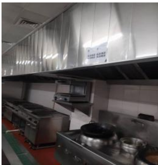
西厨房整体烟罩清洗后
