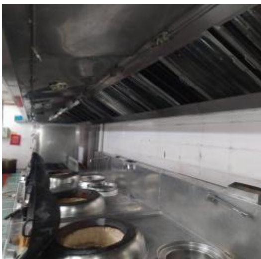
中厨房烟罩清洗前
