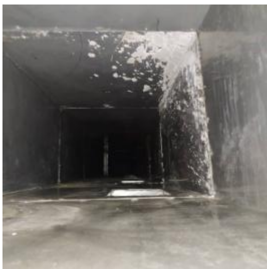
宴会厨房管道清洗前
