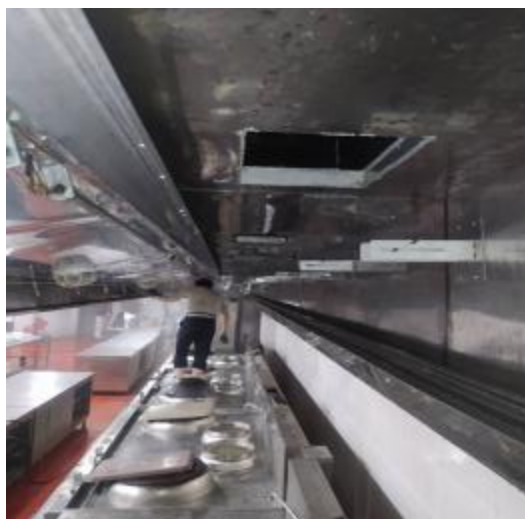
宴会厨房烟罩清洗中
