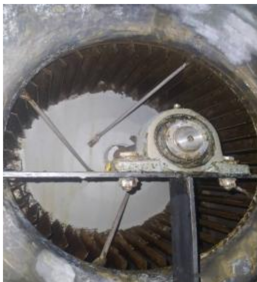
员工厨房风机清洗后
