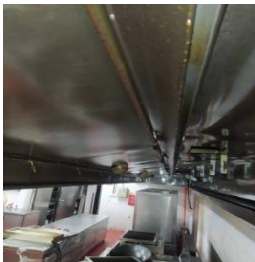
中厨房烟罩清洗前
