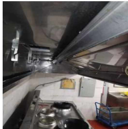
中厨房烟罩清洗后 1
