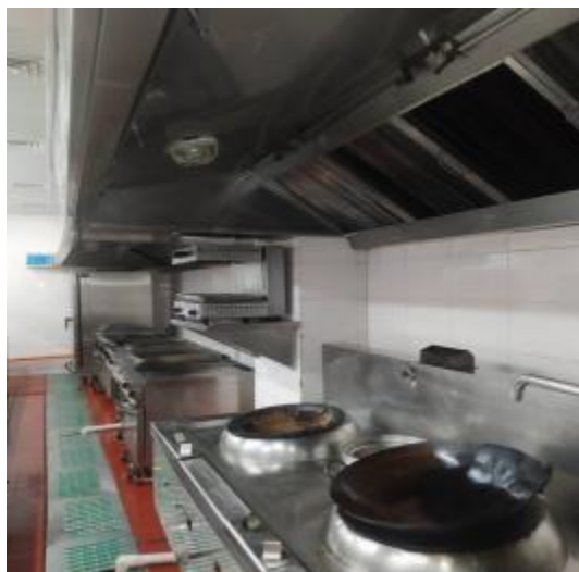
西厨房烟罩清洗前
