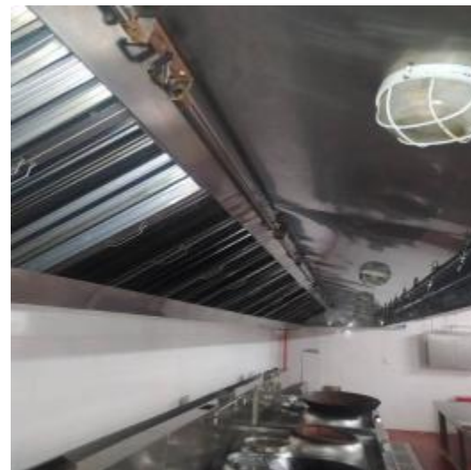
中厨房烟罩清洗后 2
