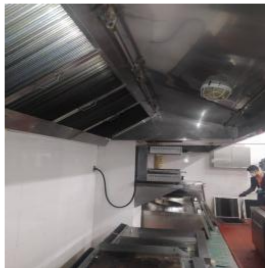
西厨房烟罩清洗中
