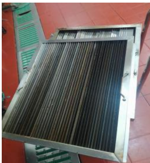
员工厨房防火板清洗前
