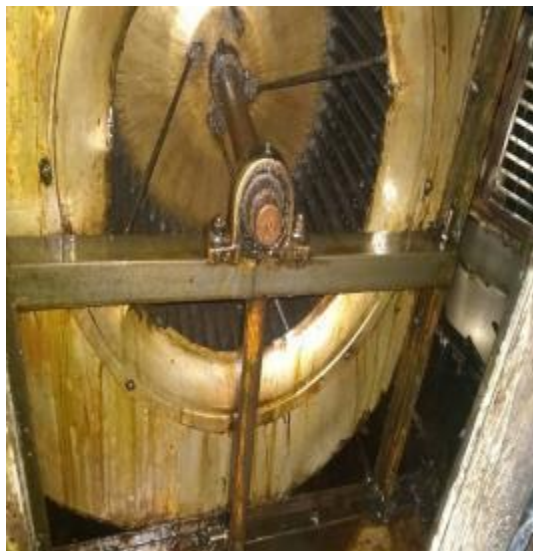
中厨房风机清洗前
