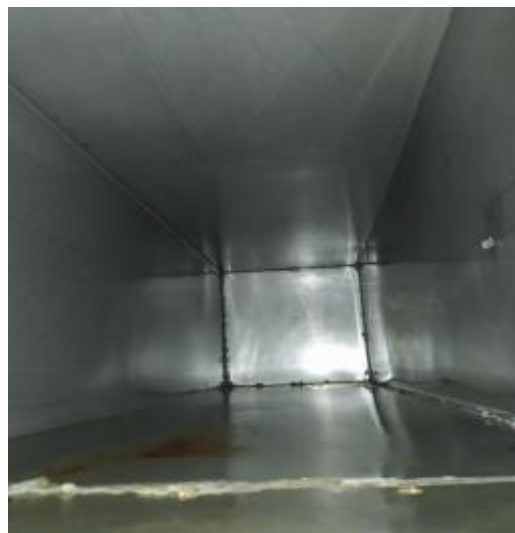
员工厨房管道清洗后
