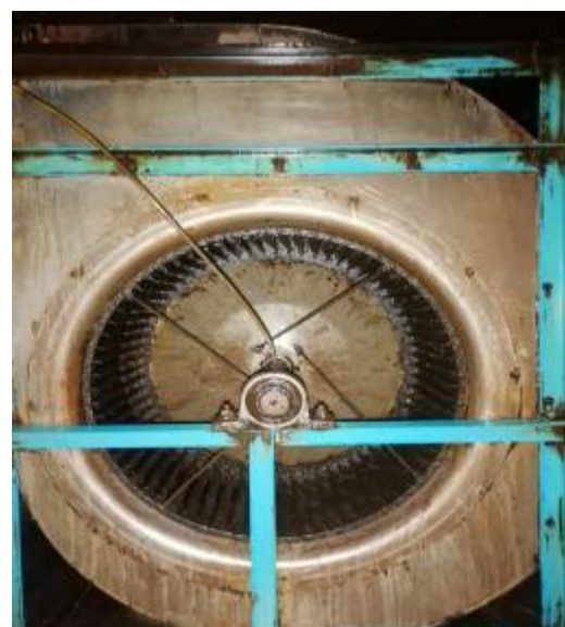
员工厨房风机清洗后
