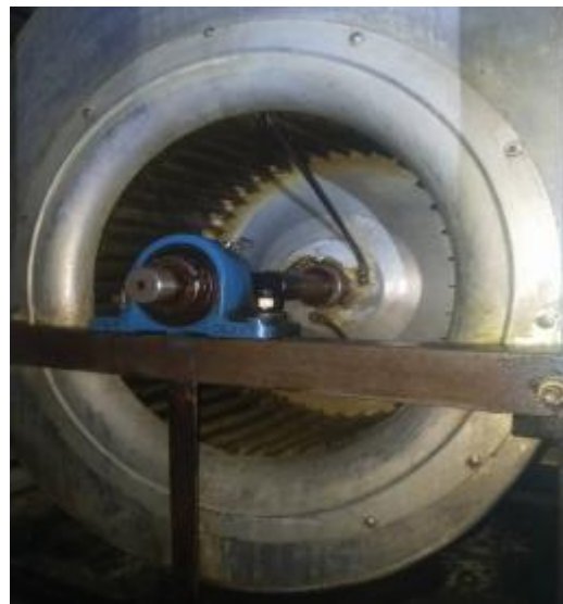
中厨房风机清洗后
