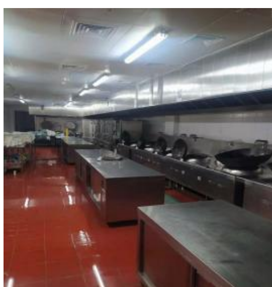
宴会厨房烟罩清洗后
