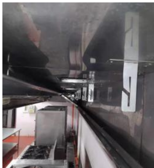
中厨房烟罩清洗后
