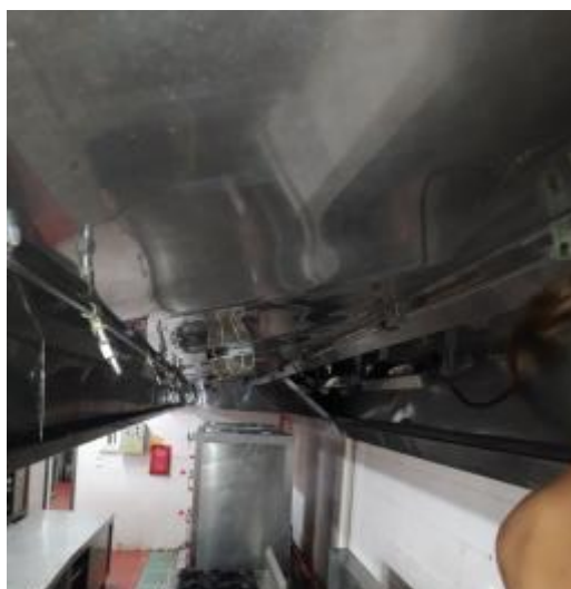
中厨房烟罩清洗后
