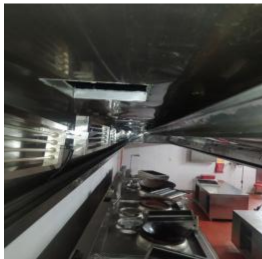
宴会厨房烟罩清洗后
