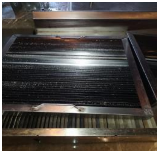
西厨房防火板清洗前
