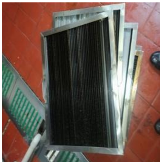
员工厨房防火板清洗前
