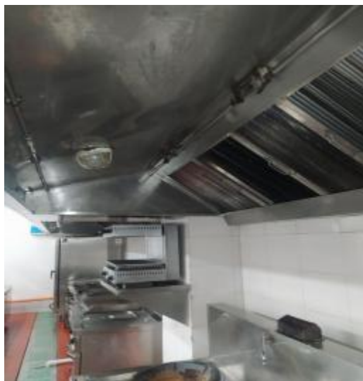
西厨房烟罩清洗前
