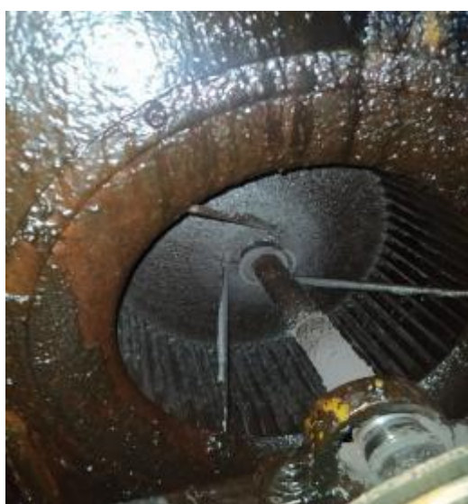
员工厨房风机清洗前
