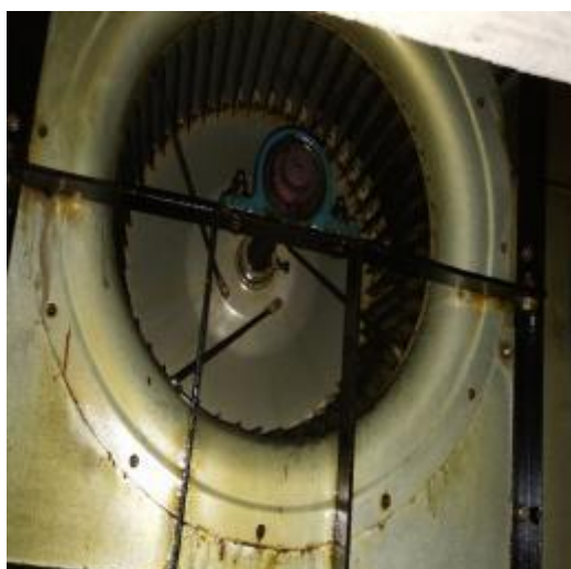
西厨风机清洗前
