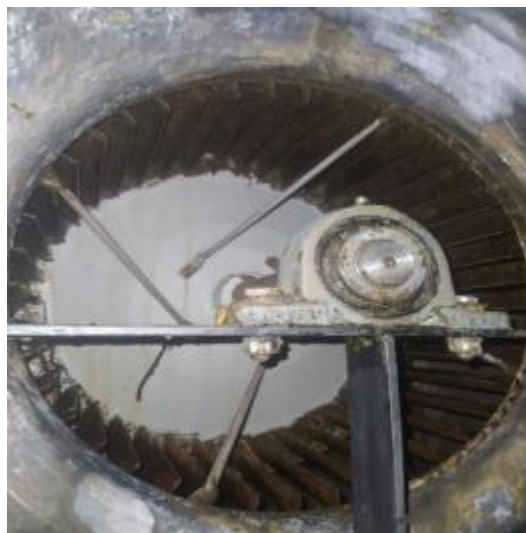
中厨房风机清洗后
