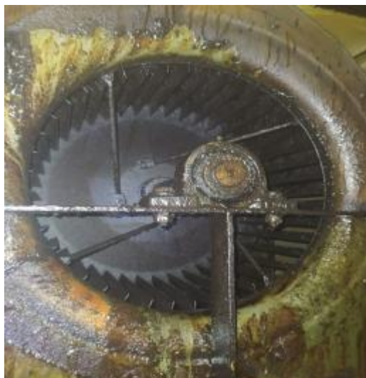
中厨房风机清洗前
