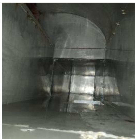
员工厨房管道清洗后
