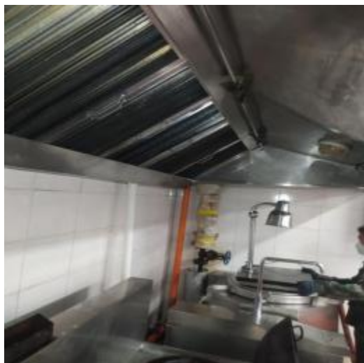
西厨房烟罩清洗前
