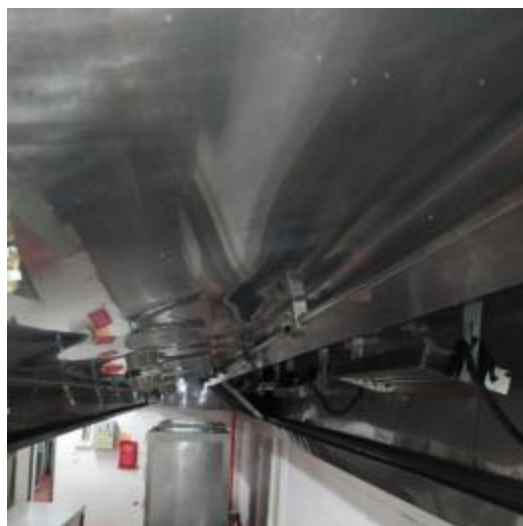
中厨房烟罩清洗后
