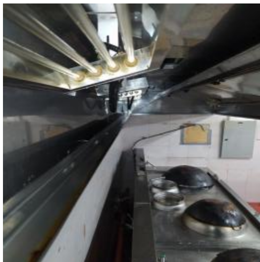
中厨房烟罩清洗前
