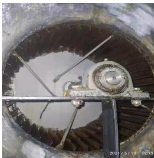
西厨风机清洗后
