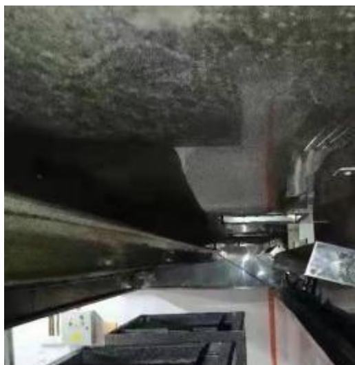
西厨房烟罩清洗前
