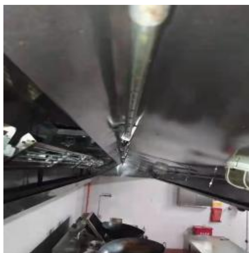
中厨房烟罩清洗后
