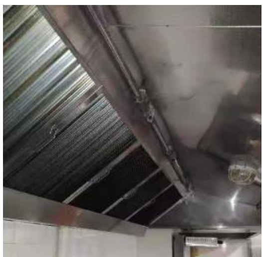
中厨房烟罩清洗前
