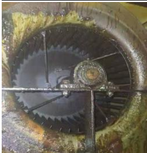
中厨房风机清洗前
