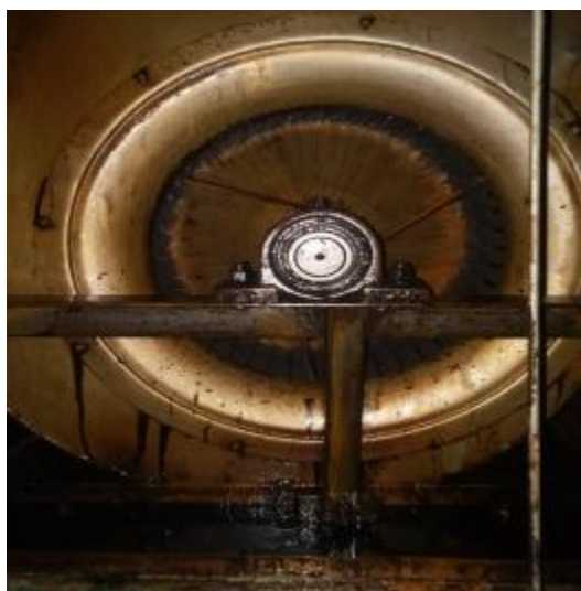
西厨风机清洗前
