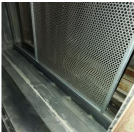
净化器机箱滤网清洗后
