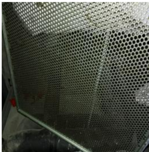
净化器机箱滤网清洗前
