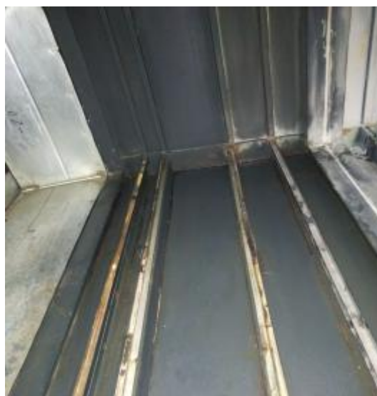
净化器机箱清洗后
