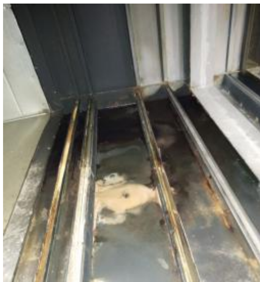
净化器机箱清洗前
