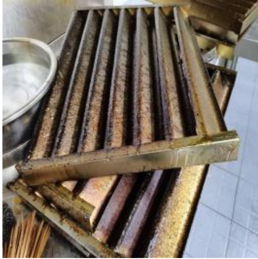
防火板清洗前
