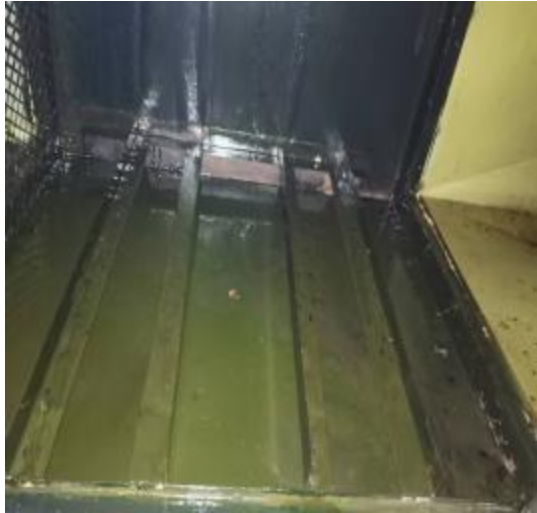
净化器机箱清洗前
