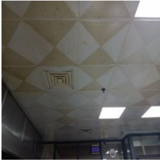
天花板清洗前
