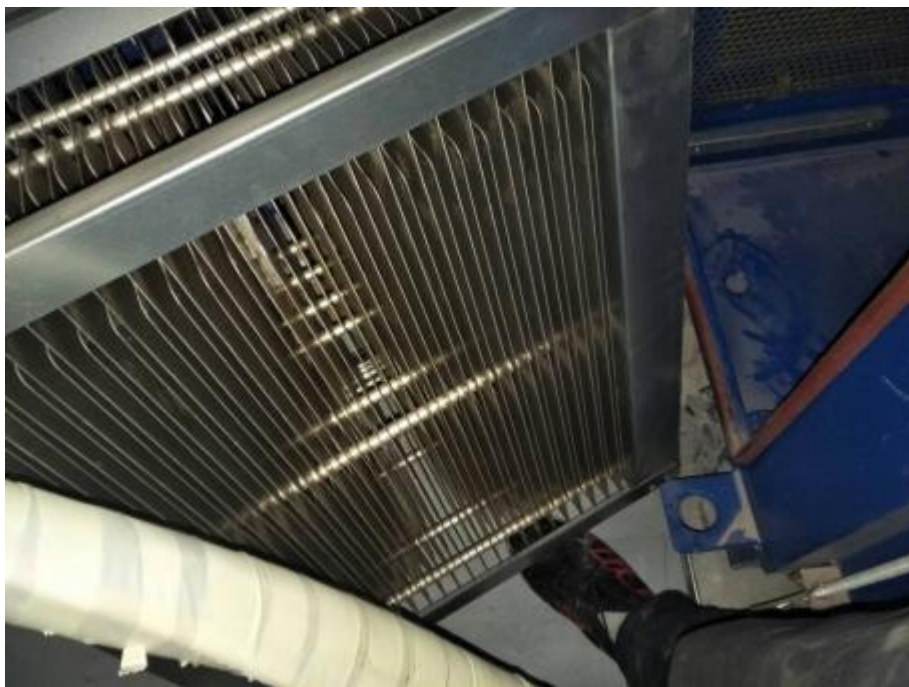
烧腊间净化器清洗后
