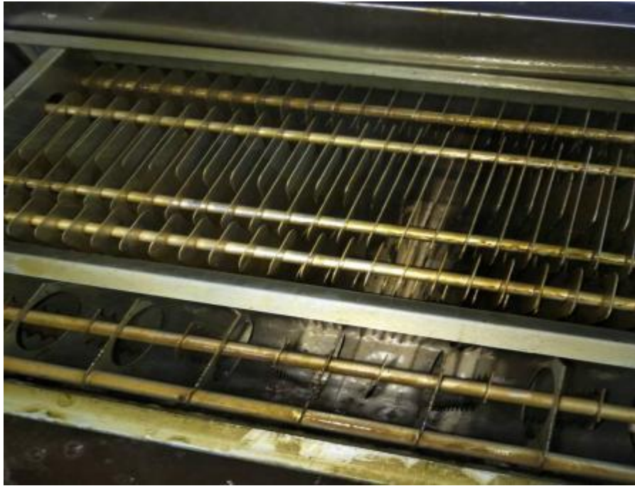
中厨房净化器清洗前
