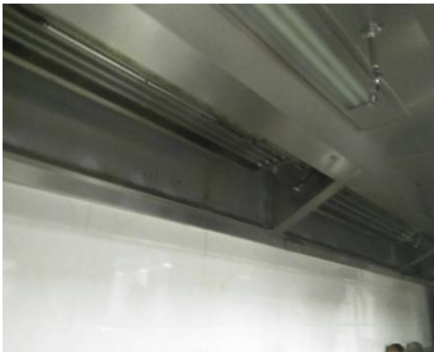
中厨房烟罩清洗前
