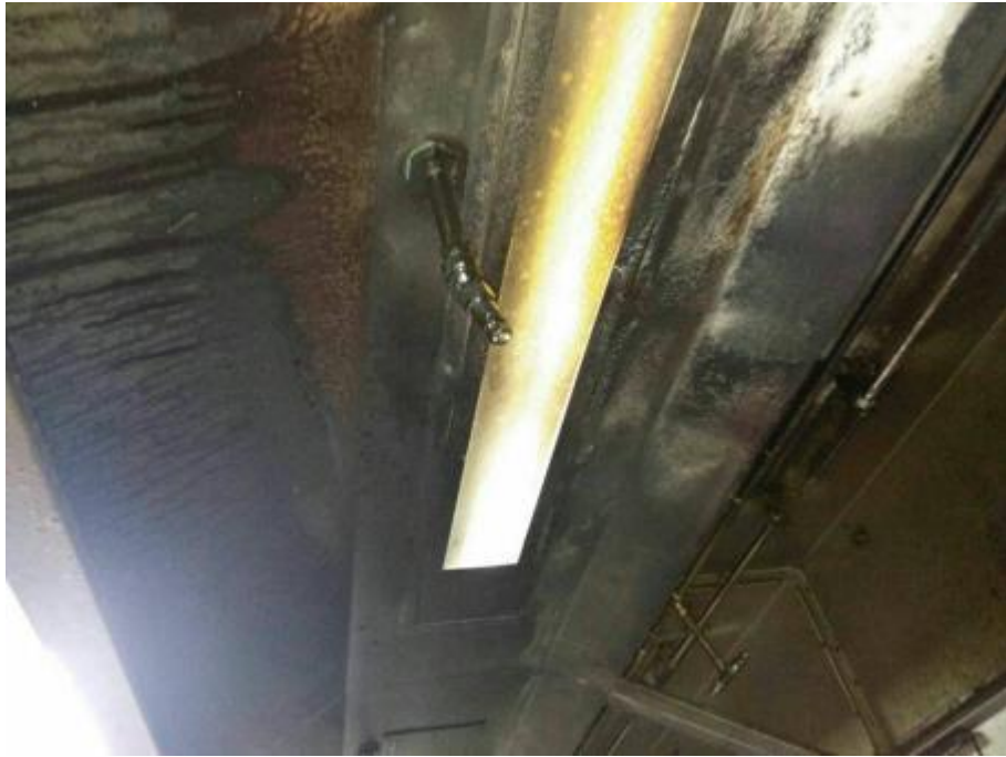
西厨房烟罩清洗前
