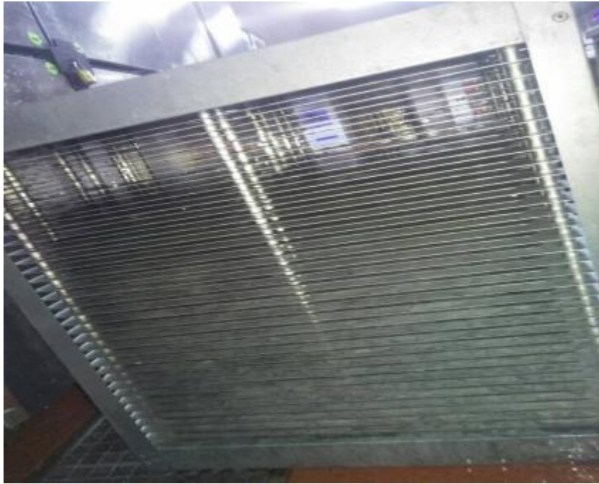
宴会厨房净化器清洗后
