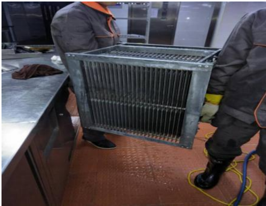
中厨房净化器清洗后
