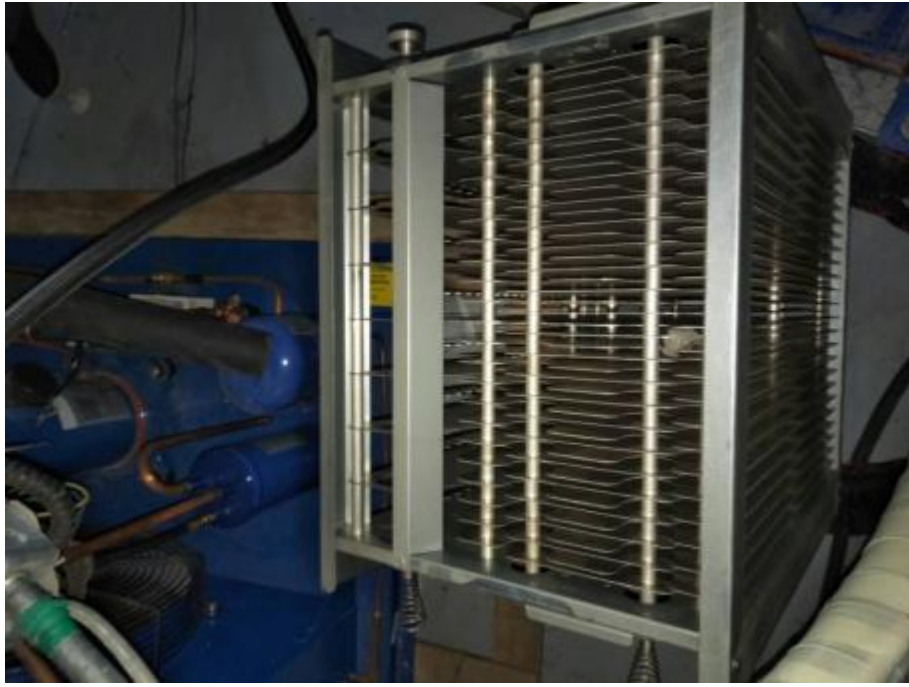
烧腊间净化器清洗前
