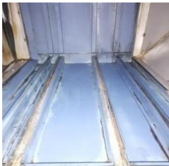
净化器机箱清洗后
