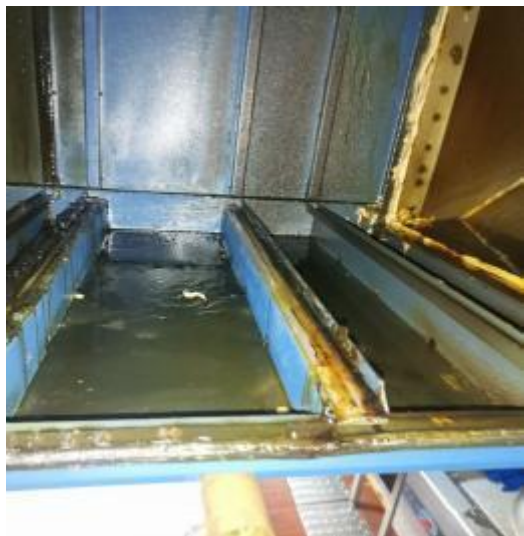
净化器机箱清洗前 1
