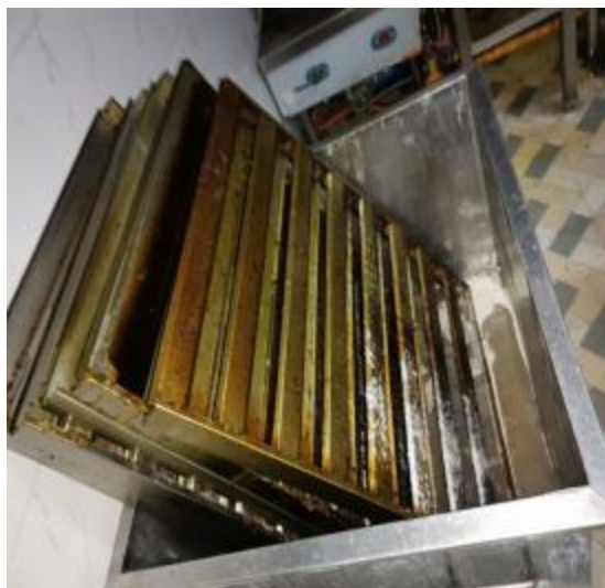
防火板清洗前
