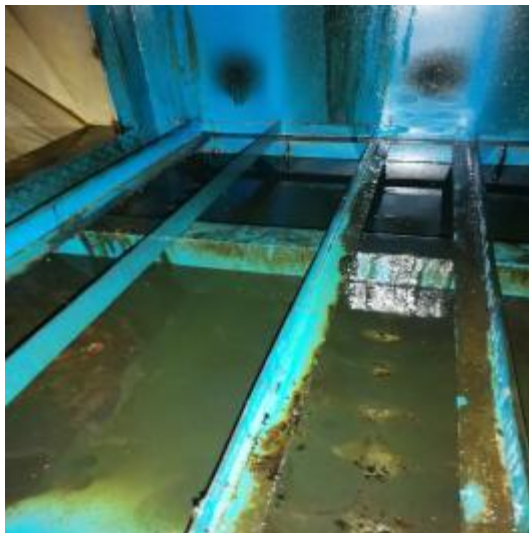
净化器机箱清洗前
