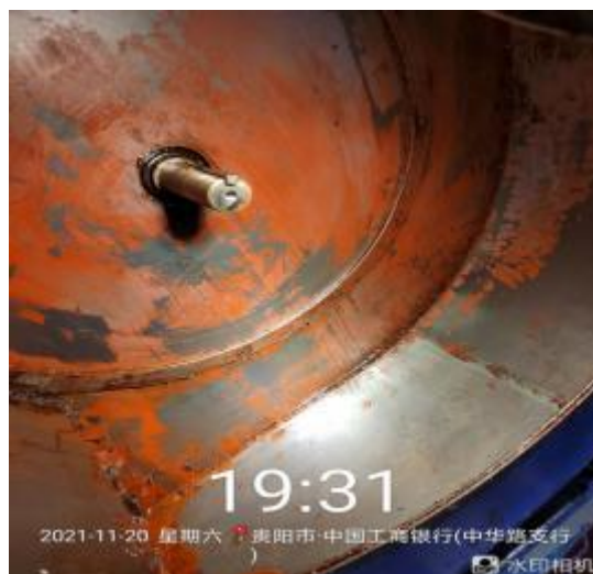
风机机箱清洗后
