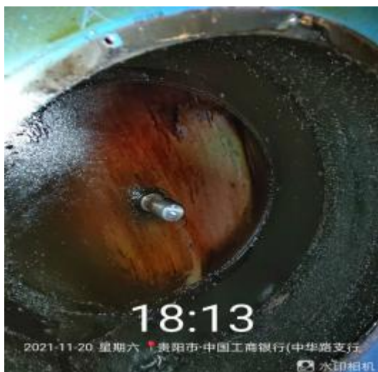
风机机箱清洗前
