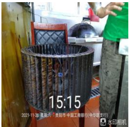
风机管叶轮清洗前
