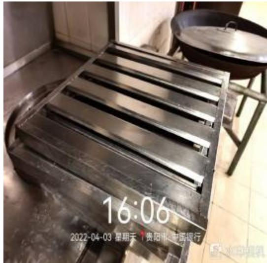
防火板清洗后
