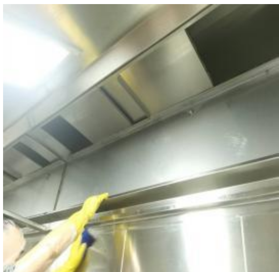
烟罩油槽清洗前
