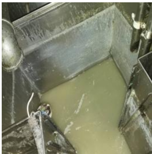
运水控制箱清洗前
