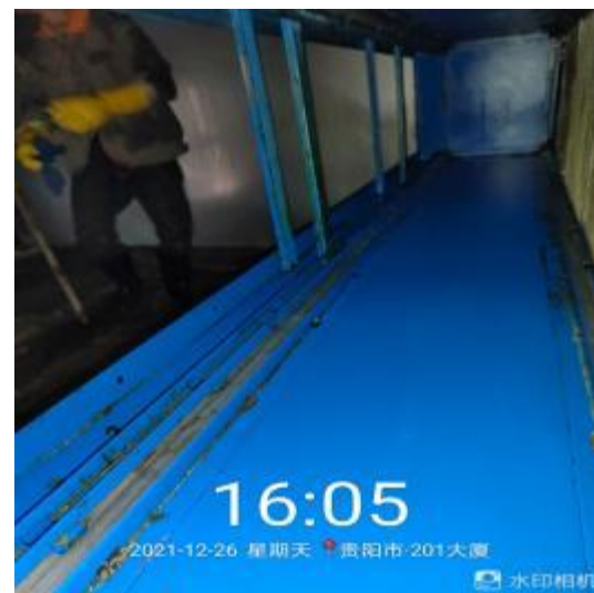
净化器机箱清洗后
