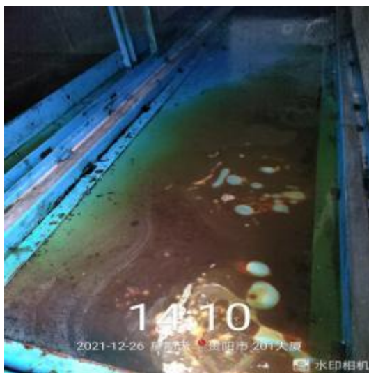
净化器机箱清洗前
