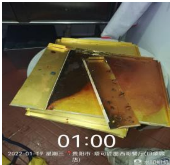
天花板清洗前
