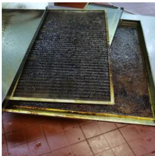
2楼过滤网清洗前
