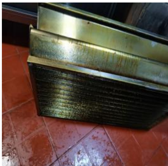
过滤器清洗前
