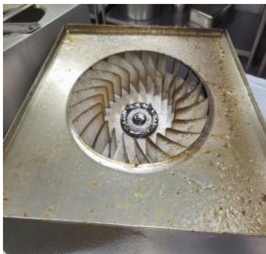
运水风扇清洗前
