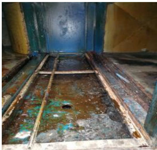
净化器机箱清洗前 2
