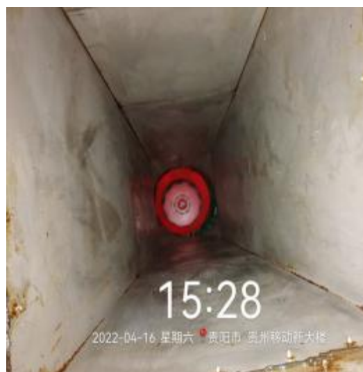
2楼管道风机清洗后
