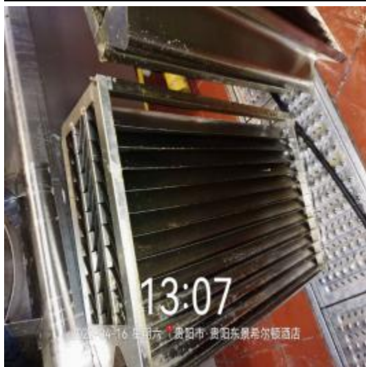
2楼过滤器清洗前
