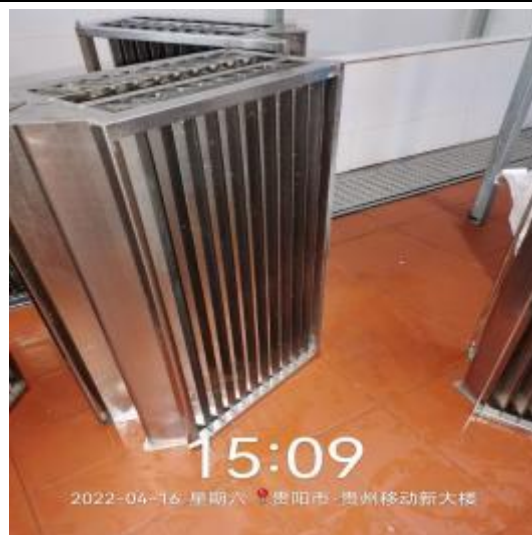
2楼过滤器清洗后
