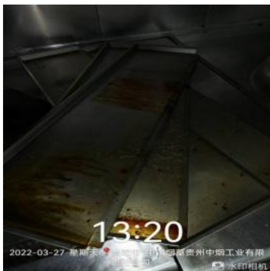
防火板清洗前
