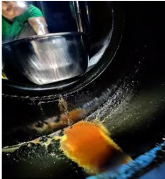
风机机箱清洗前
