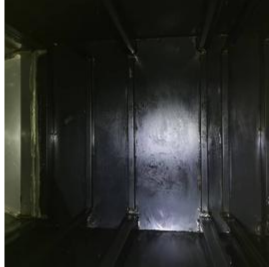
净化器机箱清洗后
