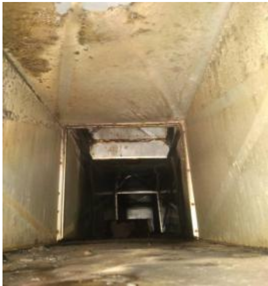
桥香园管道清洗前
