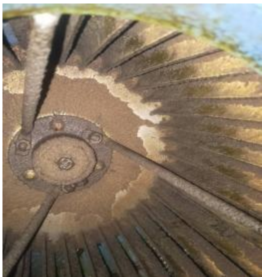
裕丰豆米火锅风机清洗前
