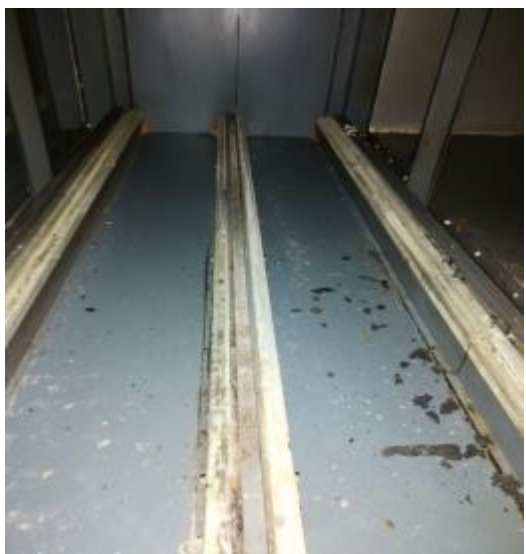
净化器内部清洗前 1
