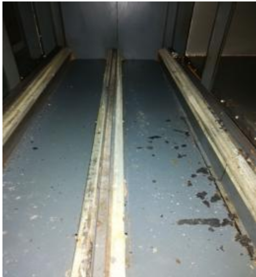
净化器内部清洗前 3
