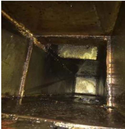
鱼天天管道清洗前
