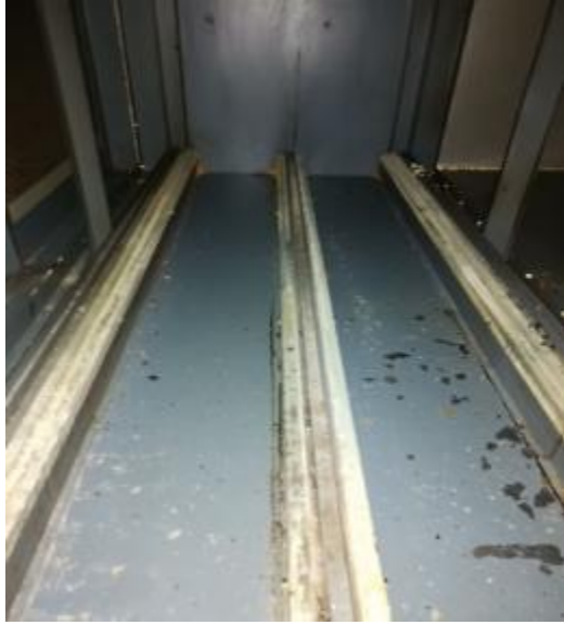
净化器内部清洗前 2
