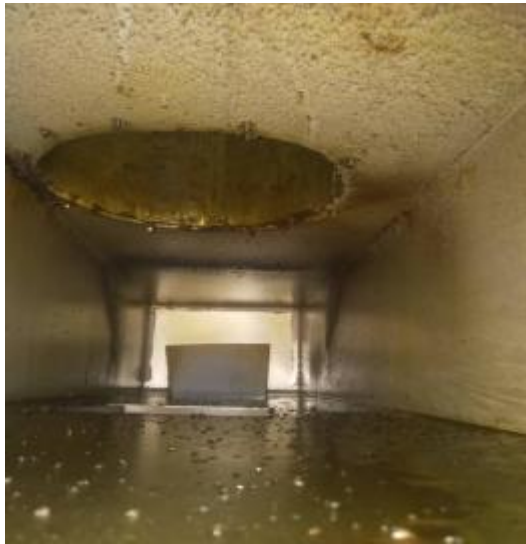
裕丰豆米火锅管道清洗前
