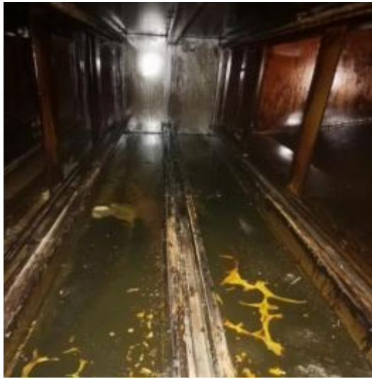
净化器机箱清洗前 1
