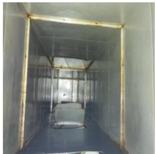
米馥管道清洗后
