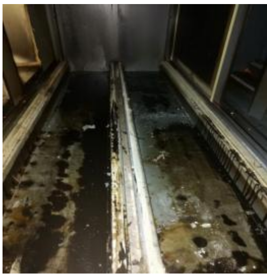
净化器机箱清洗前 2
