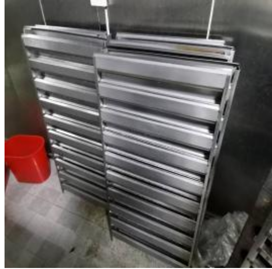
防火板清洗后
