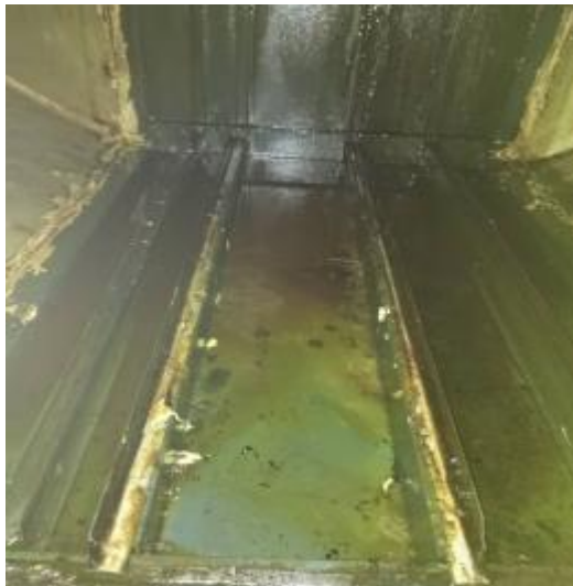
净化器机箱清洗前
