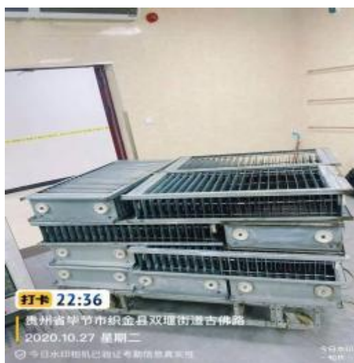
中厨房，员工厨房，烧烤房净化器清洗后
