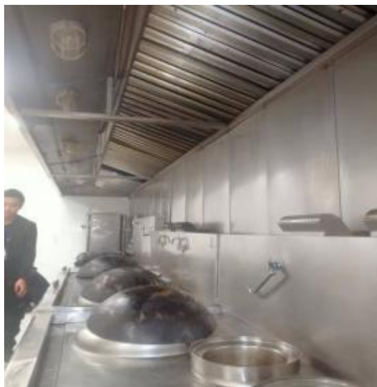
西厨房烟罩清洗前 1
