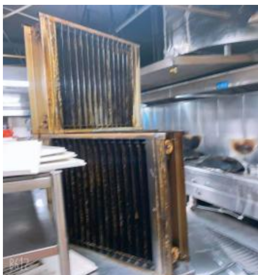
员工厨房净化器清洗前
