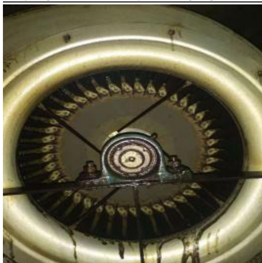
中厨房风机清洗前
