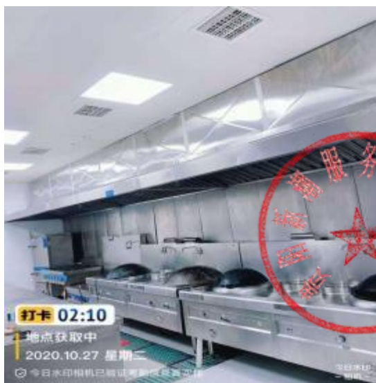
西厨房烟罩外表清洗后
