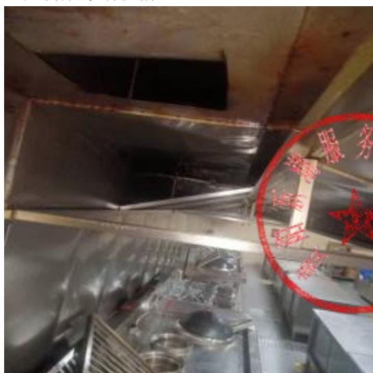
西厨房烟罩清洗前 2
