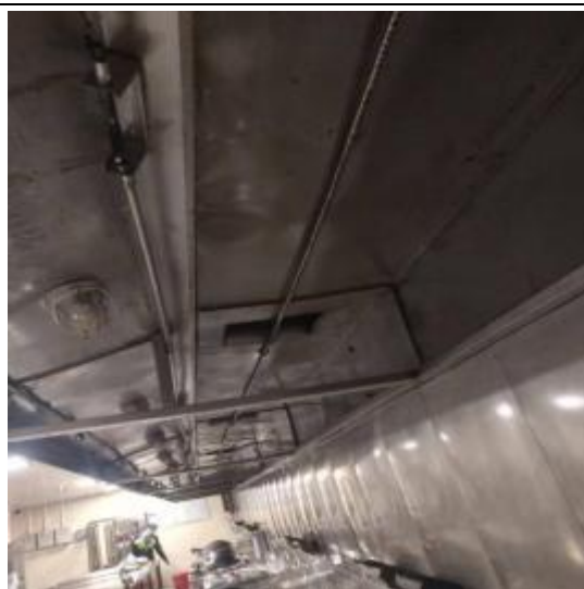
中厨房烟罩清洗后 1
