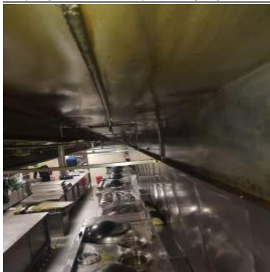
中厨房烟罩清洗前 1
