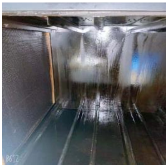
员工厨房净化器机箱清洗前
