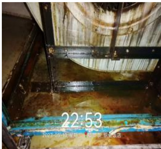
宴会厨房风机清洗前
