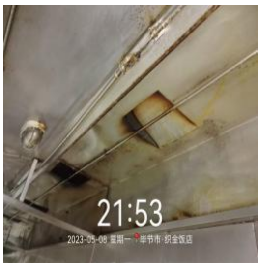
中厨房烟罩清洗前
