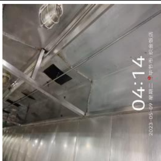
中厨房烟罩清洗后
