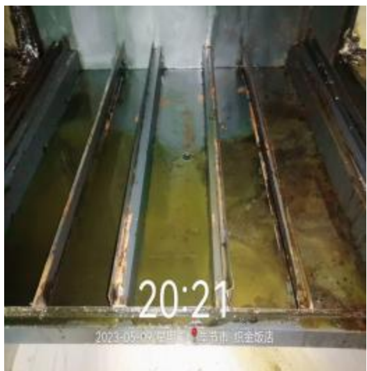
员工厨房净化器机箱清洗前
