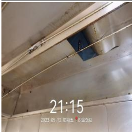
西厨房烟罩清洗前
