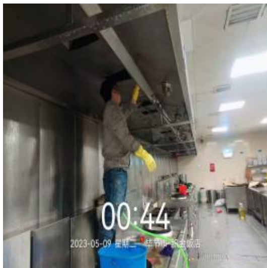
中厨房烟罩清洗中
