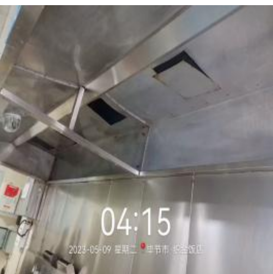
中厨房烟罩清洗后
