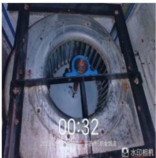
员工厨房风机清前
