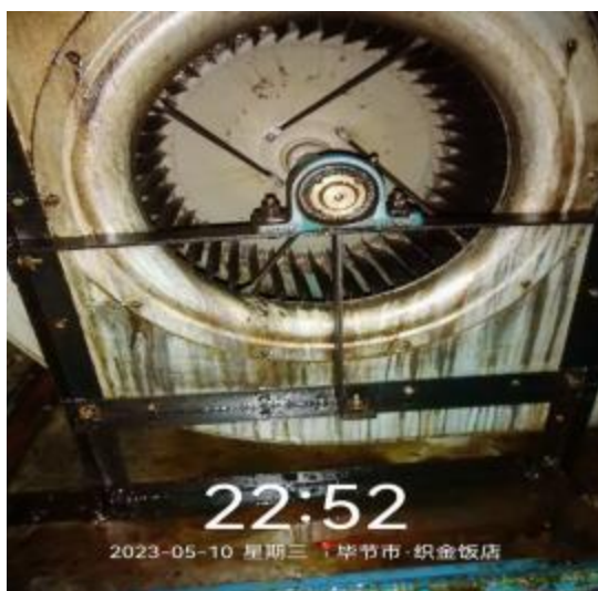
中厨房风机清洗前
