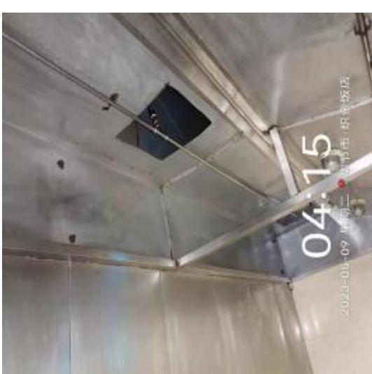
中厨房烟罩清洗后
