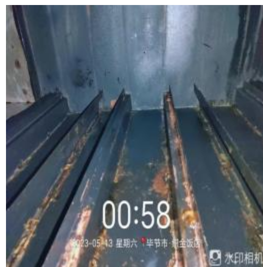
净化器机箱清洗后
