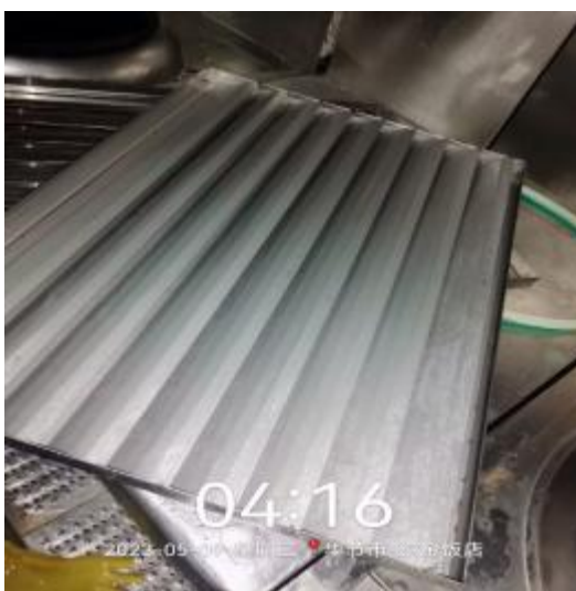
防火板清洗后
