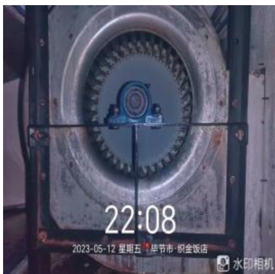
西厨房风机清洗前
