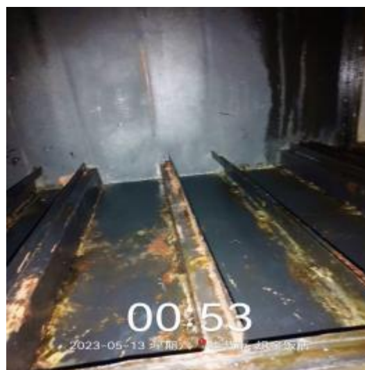
净化器机箱清洗后
