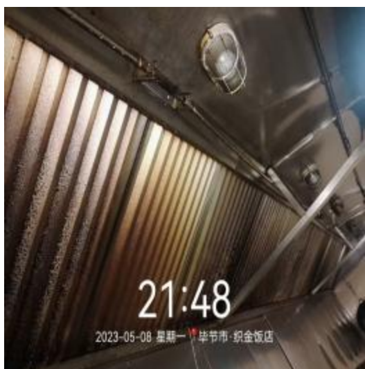
中厨房烟罩清洗前
