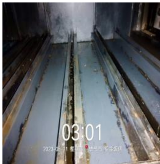
宴会厨房净化器机箱清洗后
