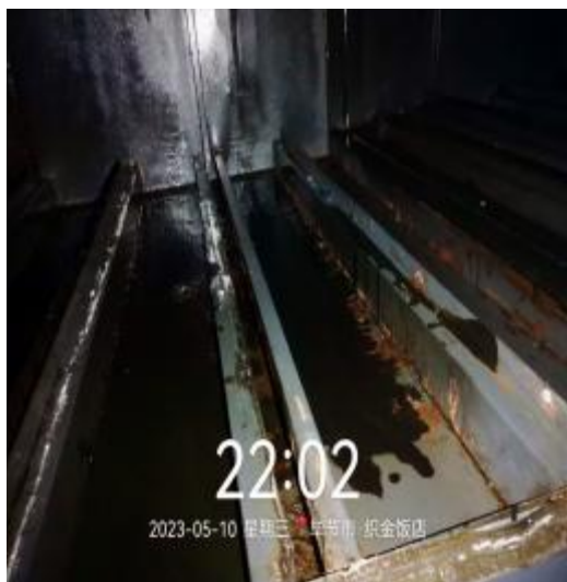
宴会厨房净化器清洗前
