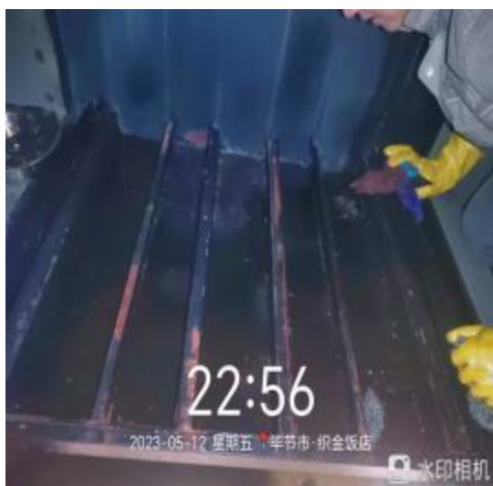
净化器机箱清洗前
