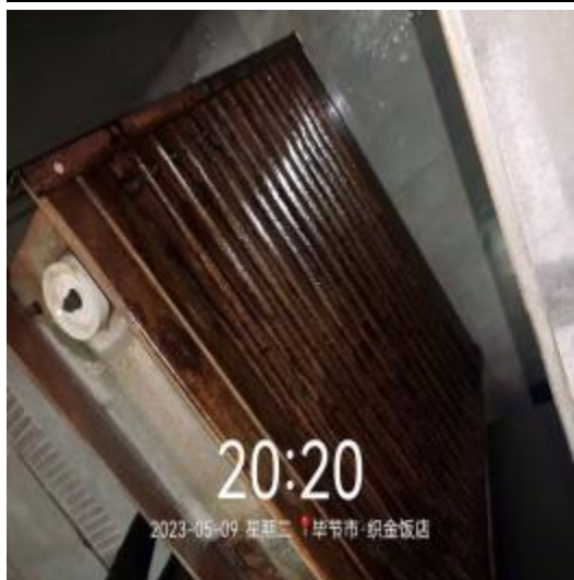
员工厨房净化器清洗前
