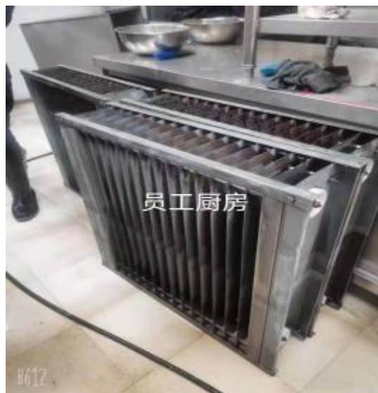
员工厨房净化器清洗后
