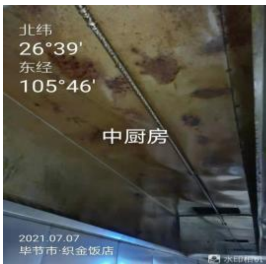
中厨房烟罩清洗前
