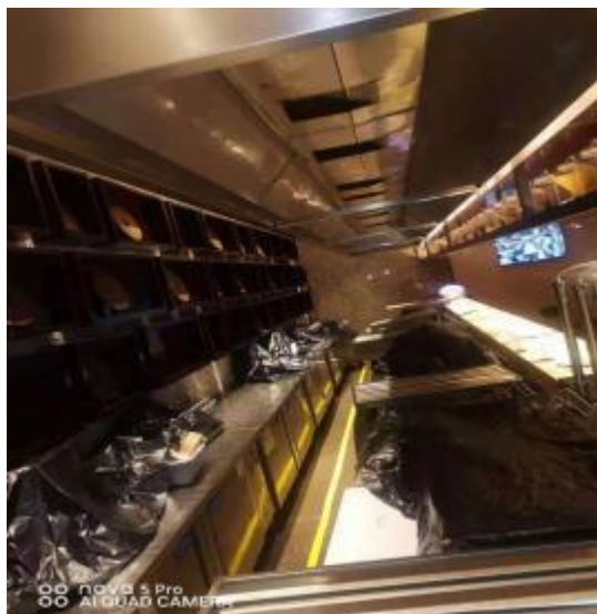
西厨房烟罩清洗前
