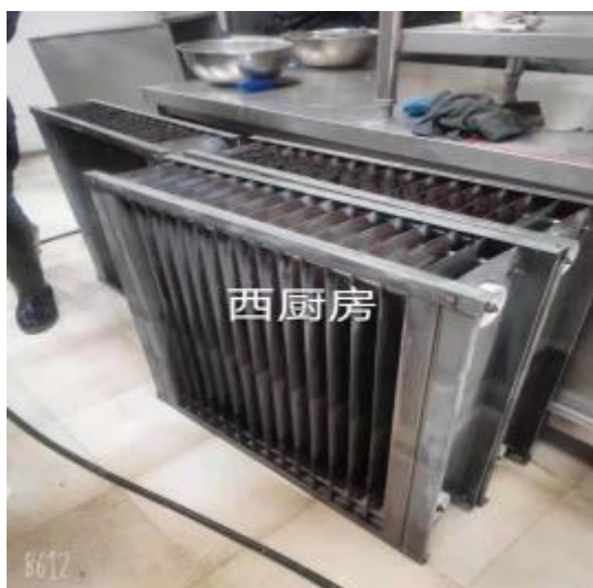
西厨房净化器清洗前
