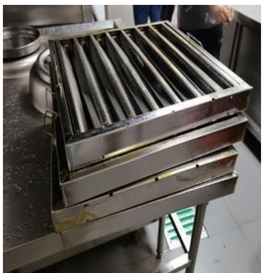
西厨房防火板清洗前
