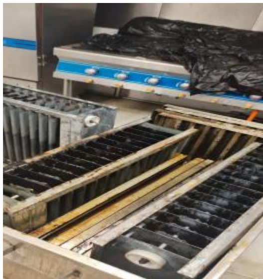
员工厨房净化器清洗前
