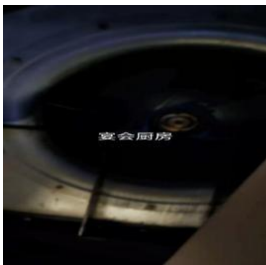
宴会厨房风机清洗前
