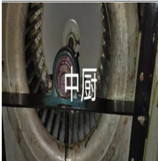
中厨房风机清洗前
