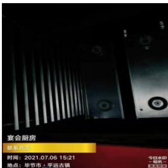
宴会厨房净化器清洗前
