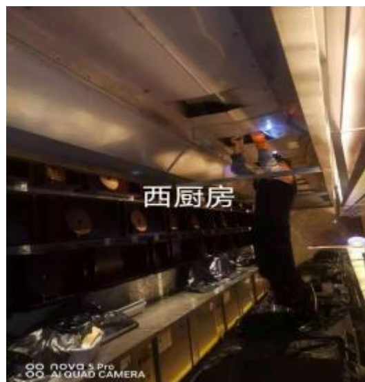
西厨房烟罩清洗中
