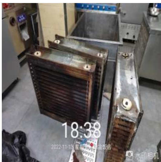
员工厨房净化器清洗前
