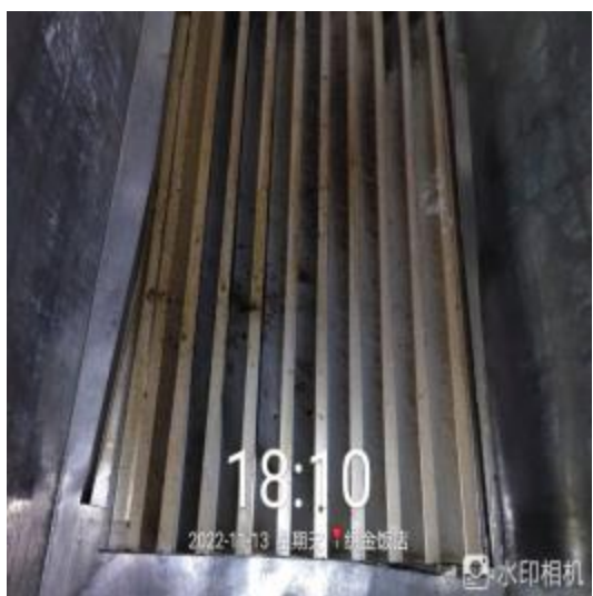
员工厨房防火板清洗前
