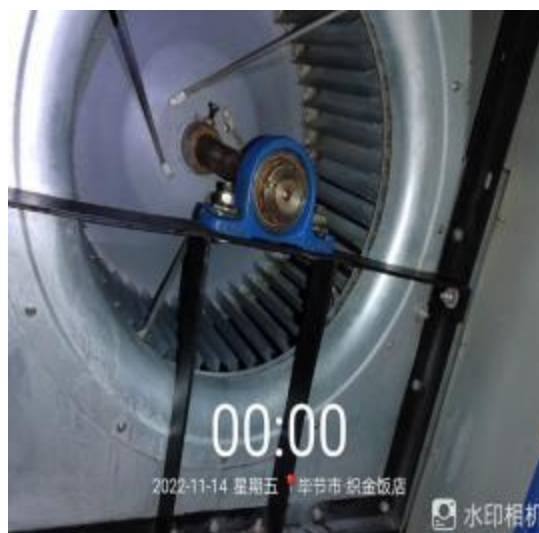
员工厨房风机清洗后
