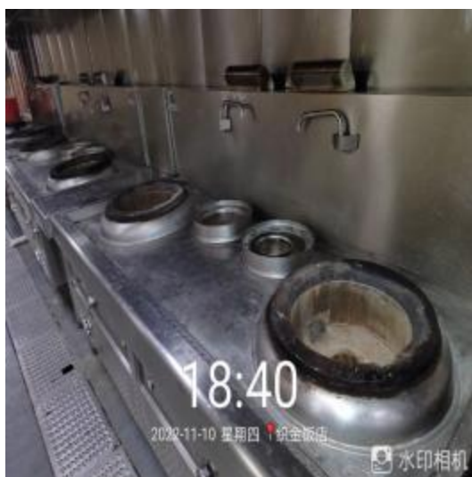
宴会厨房灶台清洗前
