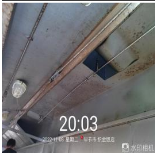
西厨房烟罩清洗前 1
