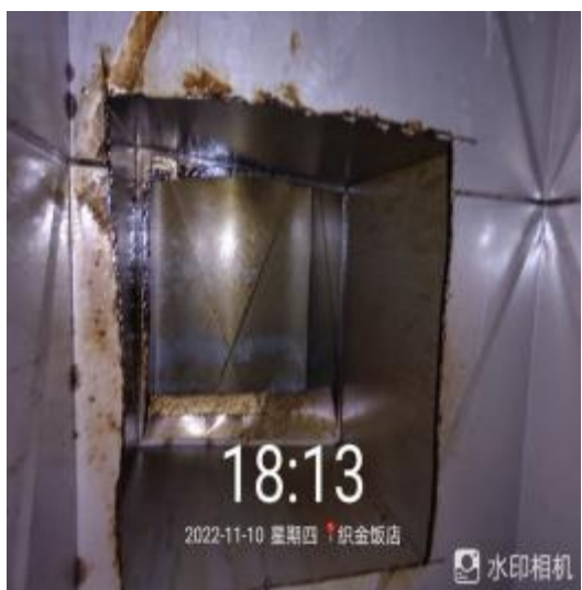
宴会厨房管道清洗前
