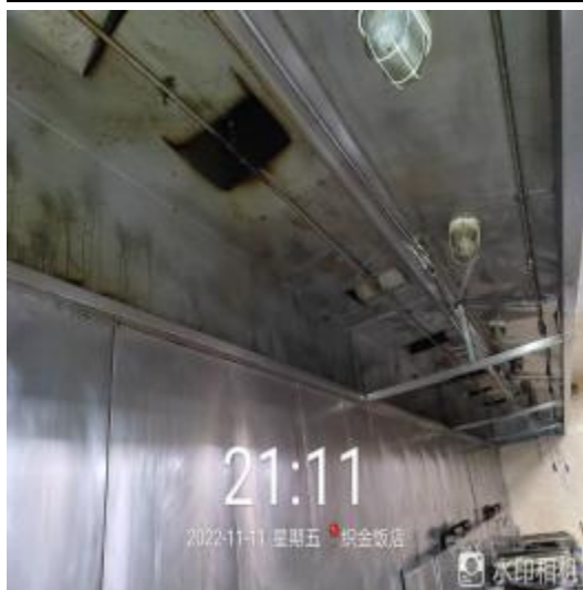
中厨房烟罩清洗前
