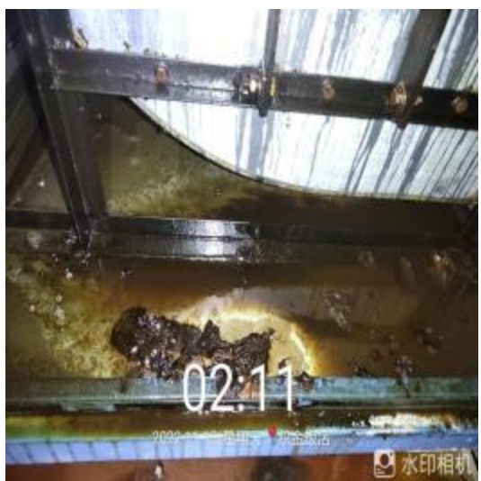
中厨房风机清洗前
