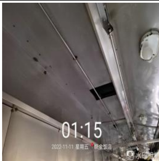
宴会厨房烟罩清洗后
