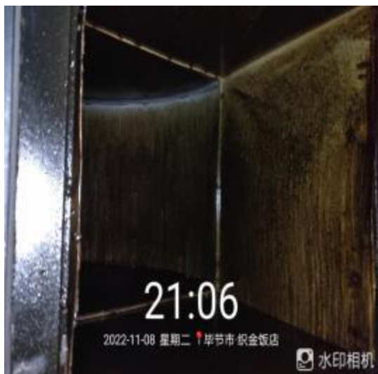
西厨房管道清洗前
