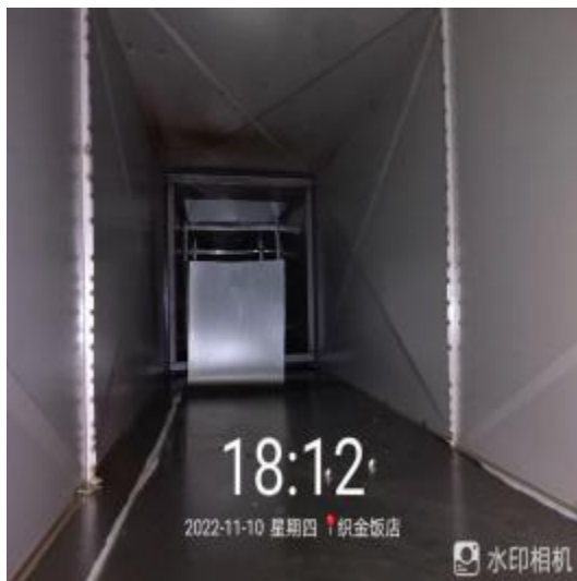
宴会厨房管道清洗前
