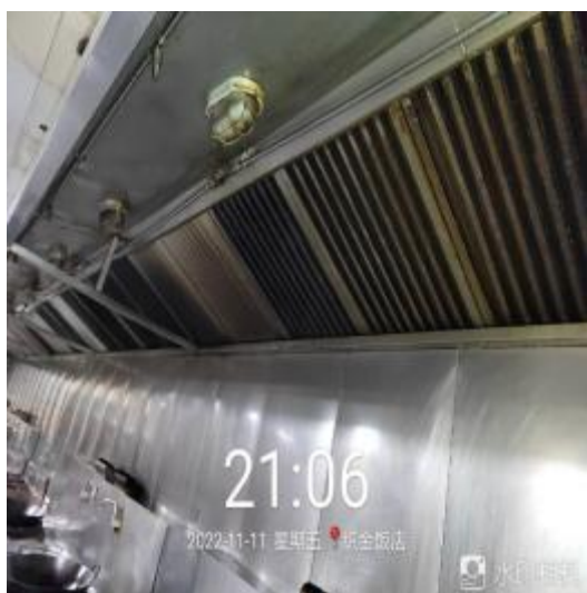
中厨房烟罩清洗前
