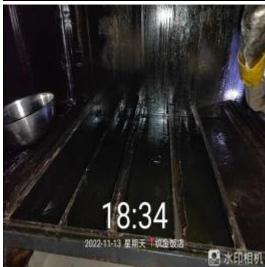
员工厨房净化器机箱清洗前
