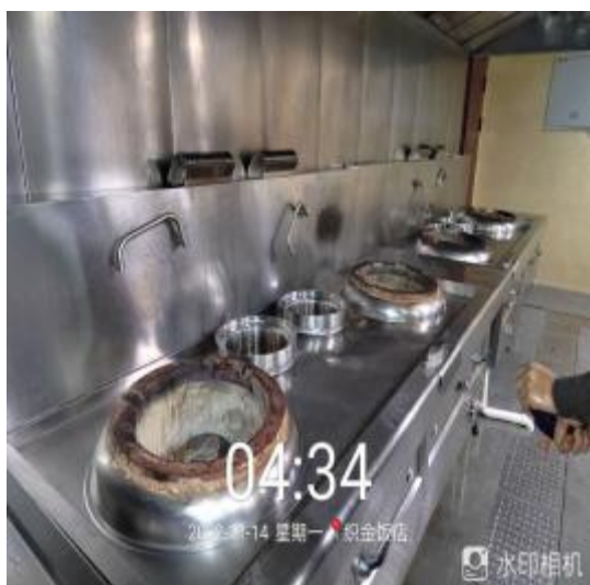
员工厨房灶台清洗后
