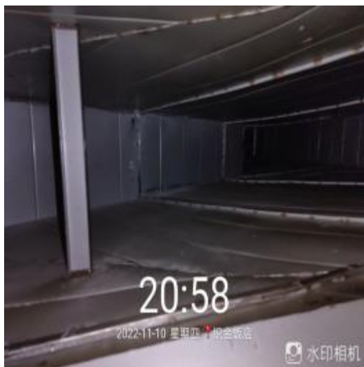
宴会厨房管道清洗前
