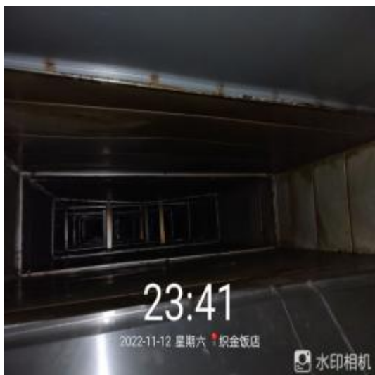
中厨房管道清洗前
