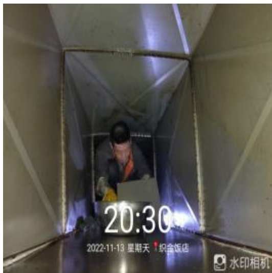
员工厨房管道清洗前
