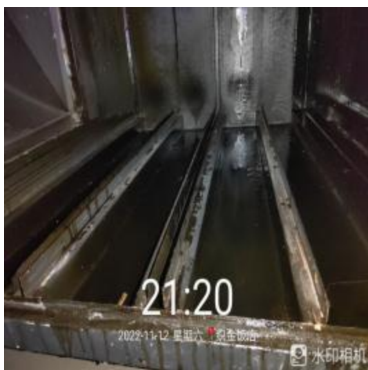
净化器机箱清洗前
