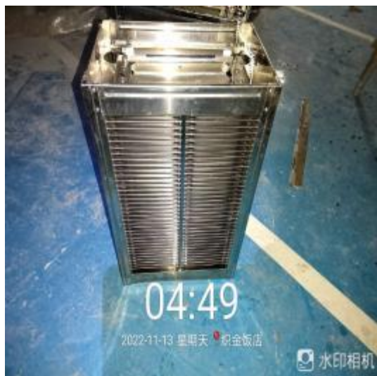
中厨房净化器清洗后
