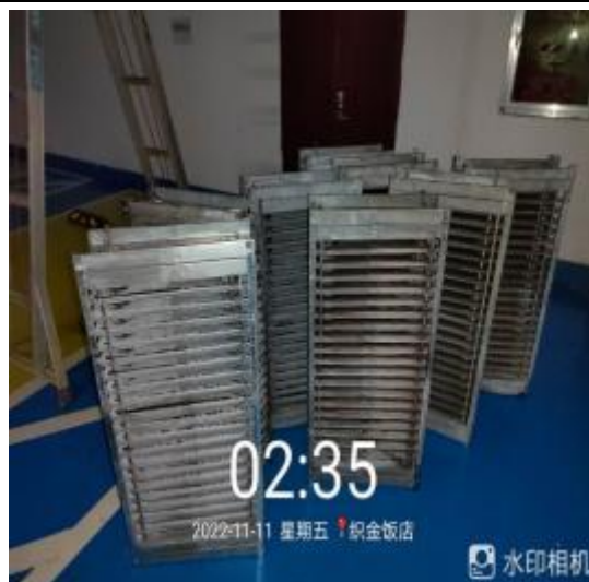
宴会厨房净化器清洗后
