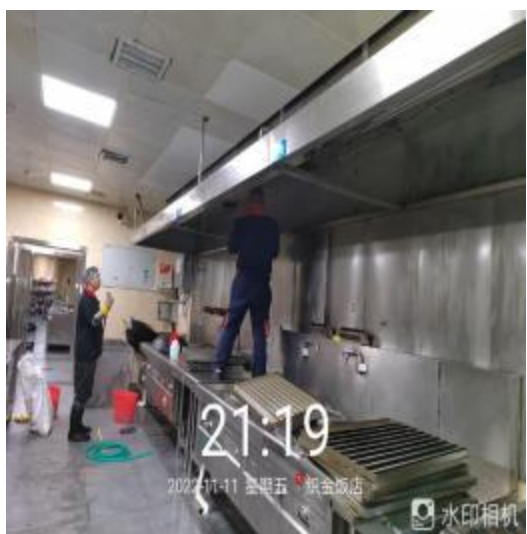
中厨房烟罩清洗中
