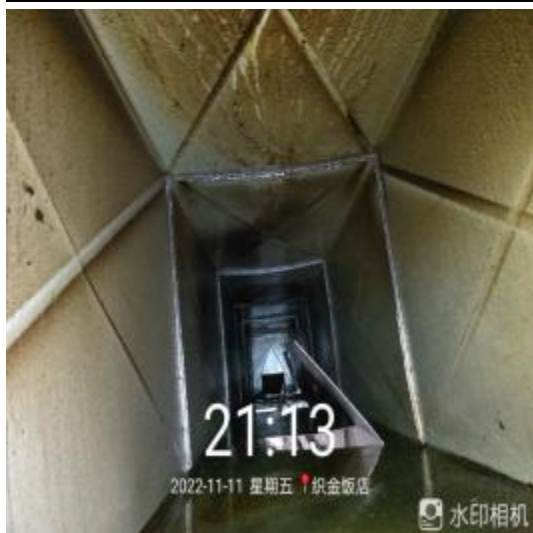
中厨房管道清洗前
