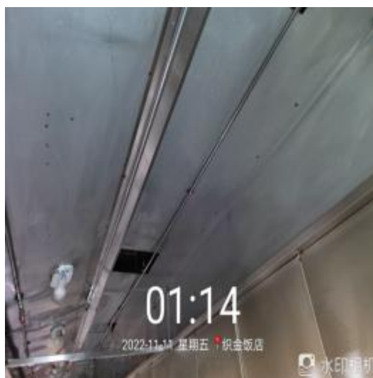
宴会厨房烟罩清洗后
