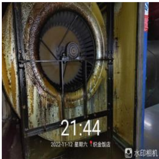
中厨房风机清洗前
