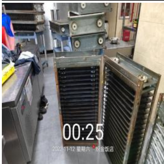
中厨房净化器清洗前
