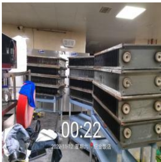
中厨房净化器清洗前
