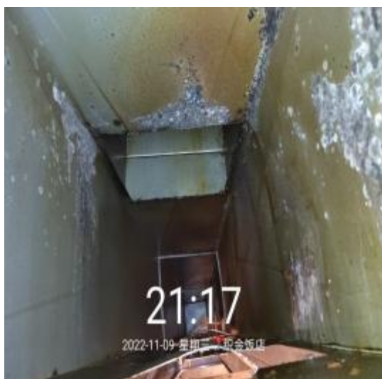
西厨房管道清洗前
