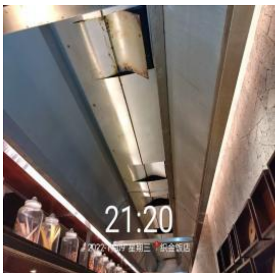
西厨房烟罩清洗前
