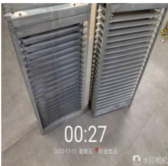
宴会厨房净化器清洗后
