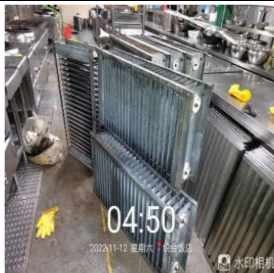
中厨房净化器清洗后
