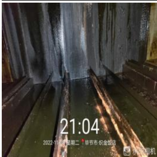
净化器机箱清洗前
