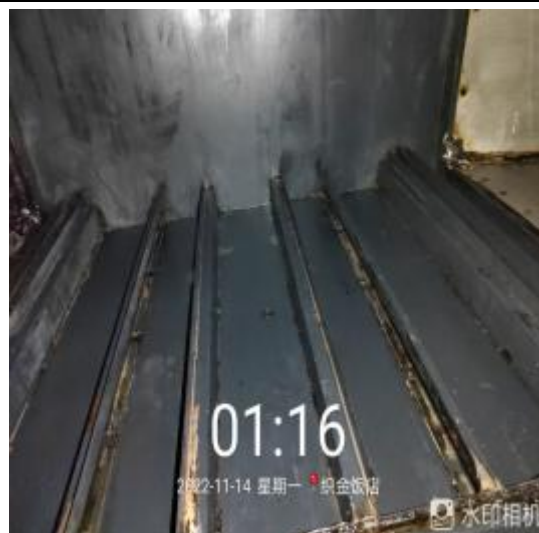
员工厨房净化器机箱清洗后
