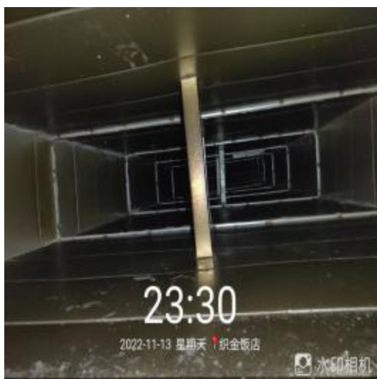
员工厨房管道清洗前
