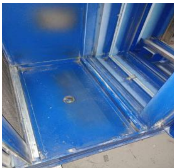
净化器机箱清洗前
