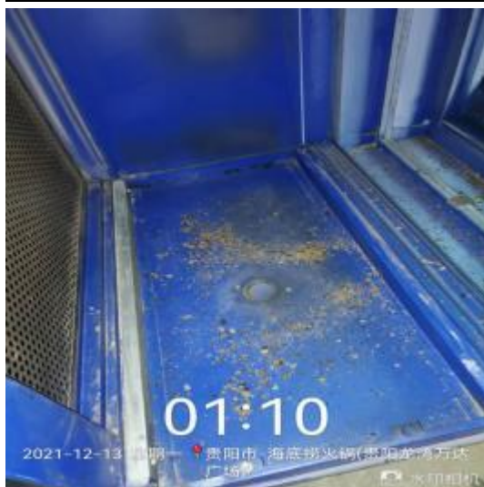
净化器机箱清洗前
