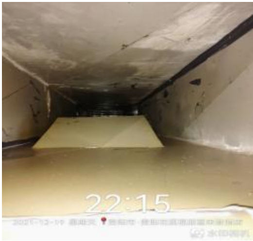
二楼管道清洗前
