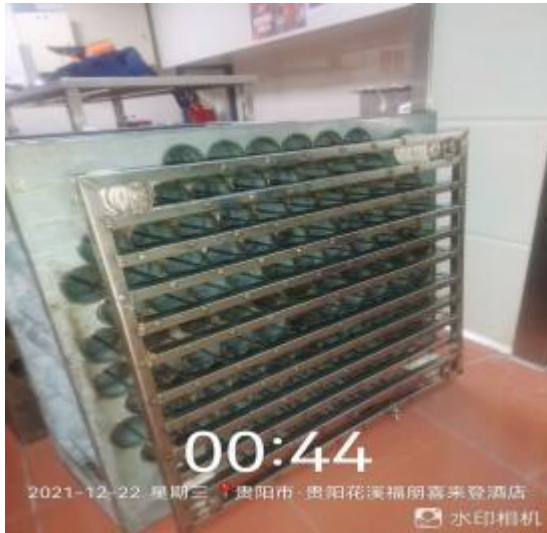
员工厨房净化器清洗前
