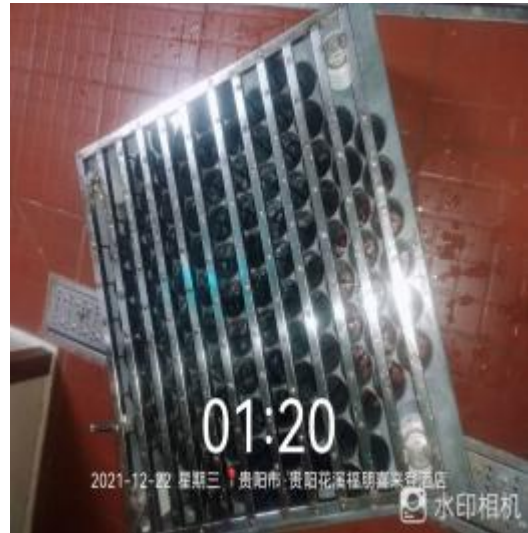
员工厨房净化器清洗后
