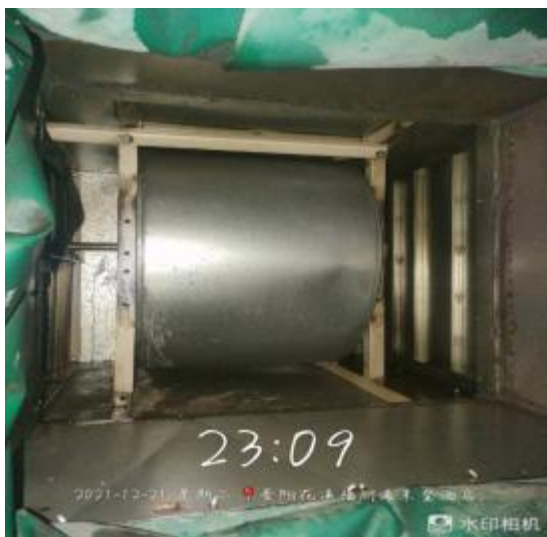
员工厨房风机清洗前
