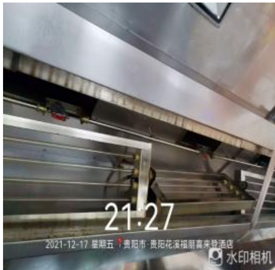
四楼厨房烟罩清洗前 1
