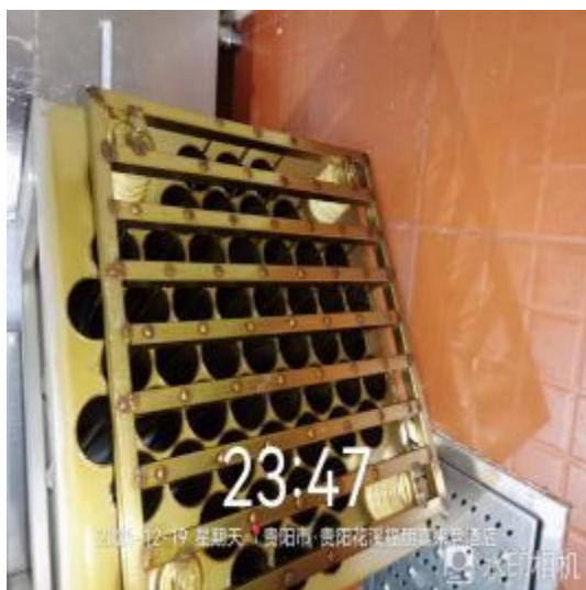
二楼净化器清洗前
