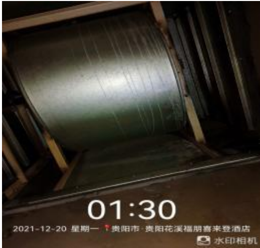
二楼风机清洗前
