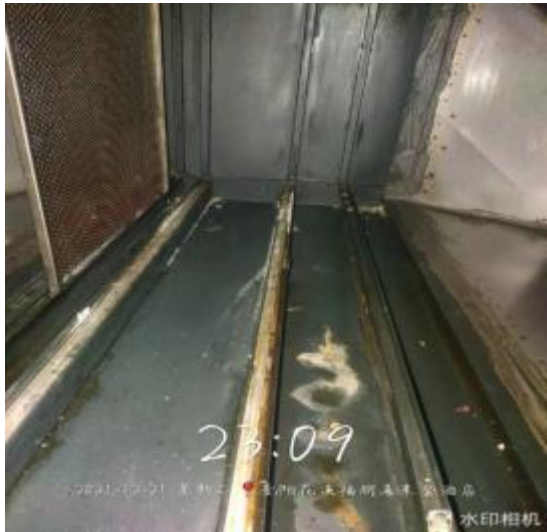
员工厨房净化器机箱清洗前
