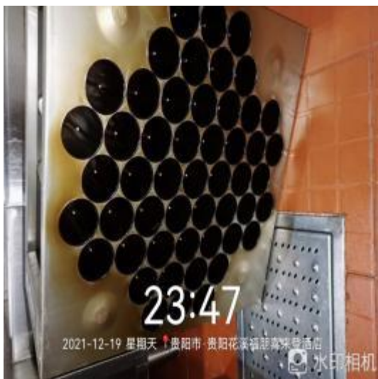
二楼净化器清洗前
