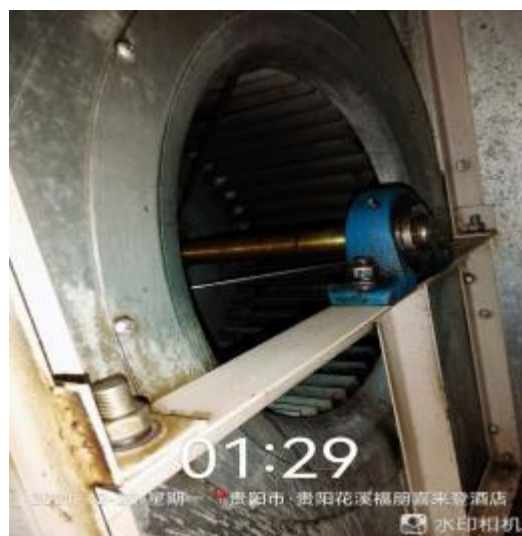
二楼风机清洗前
