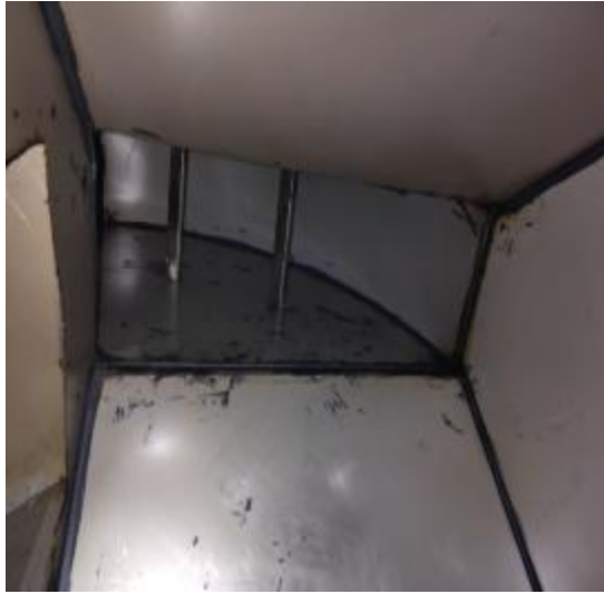
二楼管道清洗前
