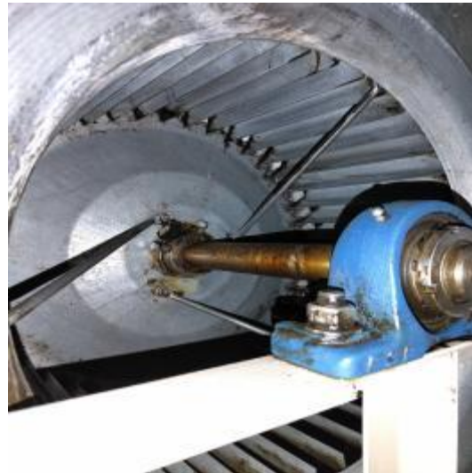
员工厨房风机清洗后
