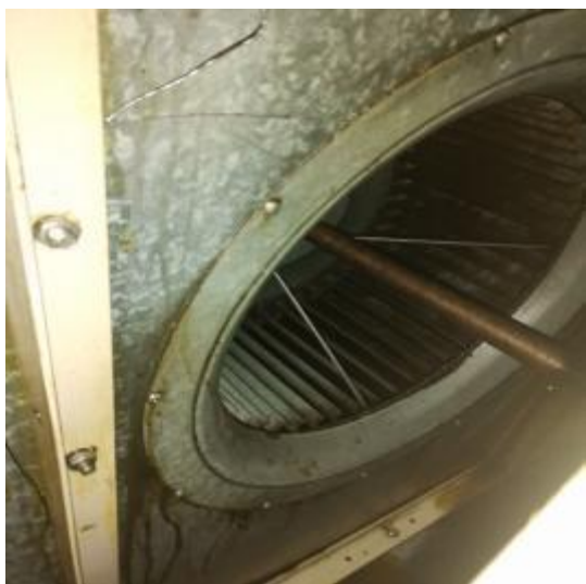
四楼风机清洗前 1
