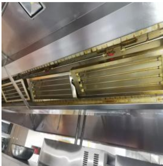
四楼厨房烟罩清洗前 1
