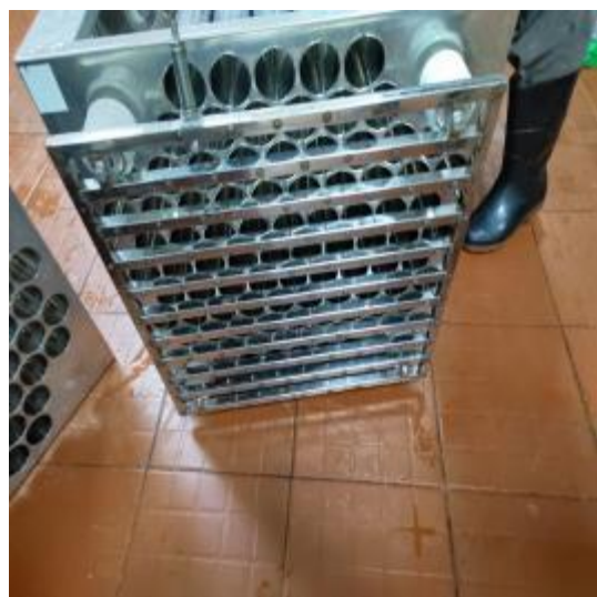
四楼净化器清洗后
