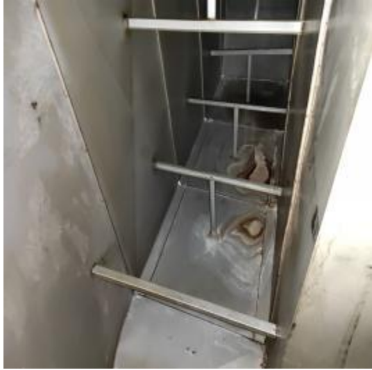
顶楼管道清洗前 2
