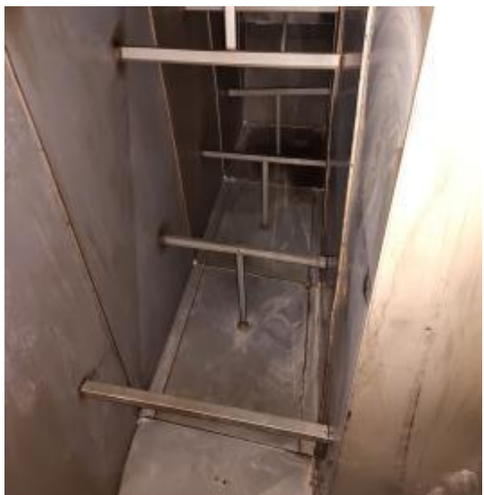
顶楼管道清洗前 1
