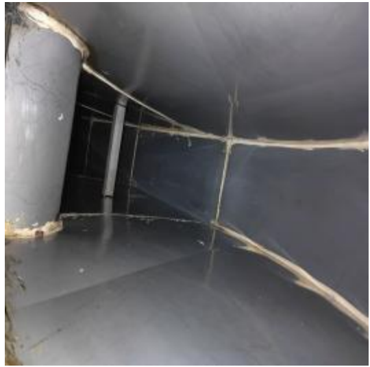
员工厨房管道清洗后 2
