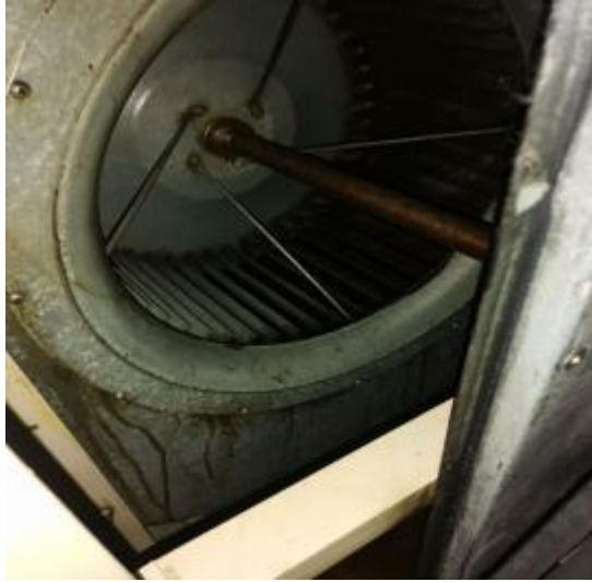
二楼风机清洗前
