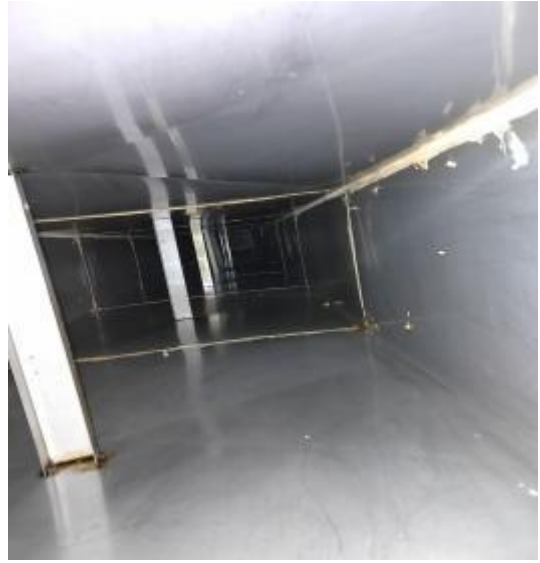
员工厨房管道清洗后 1
