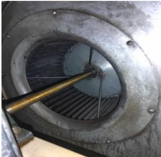
员工厨房风机清洗前
