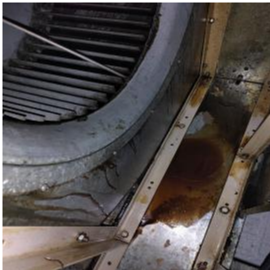
二楼风机清洗前
