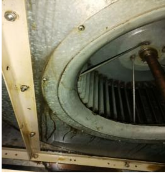
四楼风机清洗前 2
