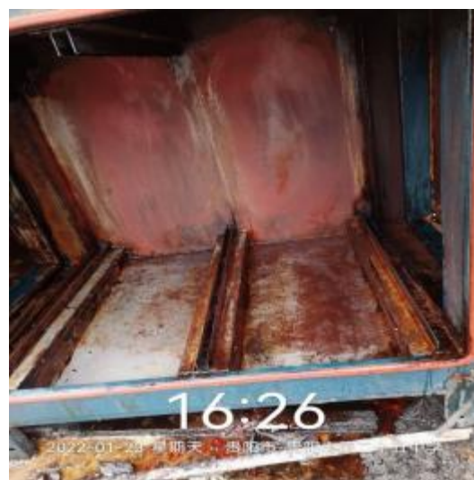
净化器机箱清洗后
