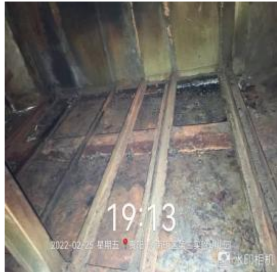
净化器机箱清洗后
