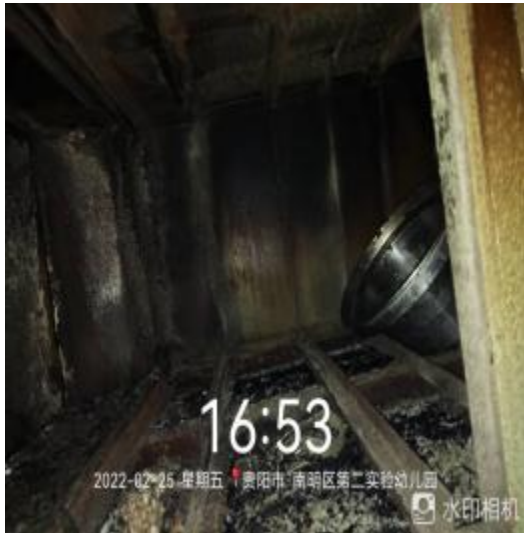
净化器机箱清洗前
