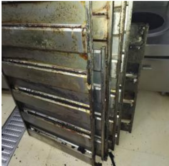
防火板清洗前
