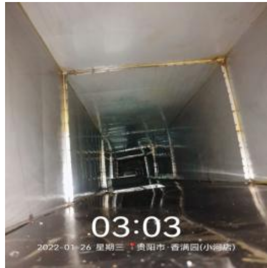
防火板清洗后
