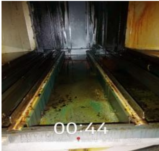
净化器机箱清洗前
