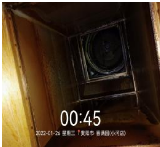
风机管道清洗前
