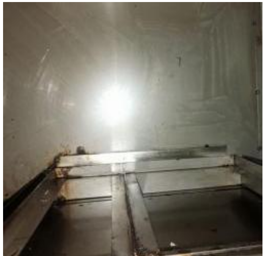
净化器机箱清洗后
