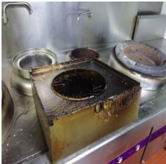
运水风扇清洗前
