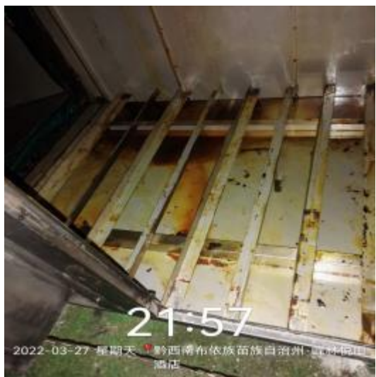
净化器机箱清洗前
