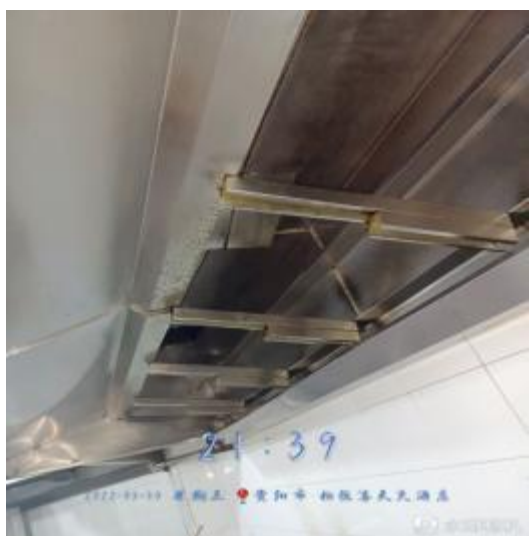
西厨房烟罩清洗前
