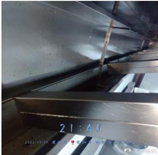
西厨房烟罩清洗前
