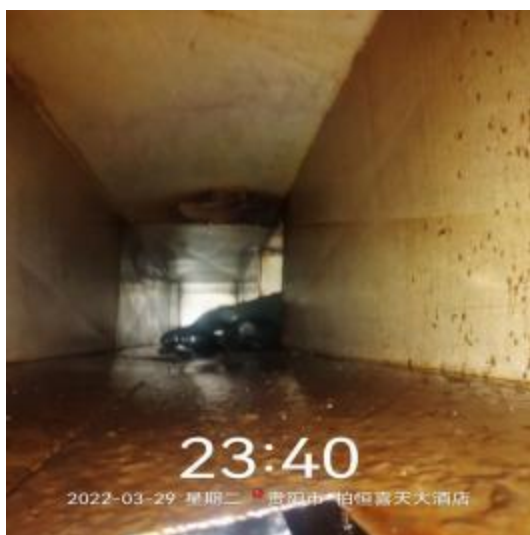
中厨房管道清洗前
