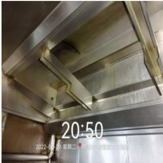
中厨房烟罩清洗前
