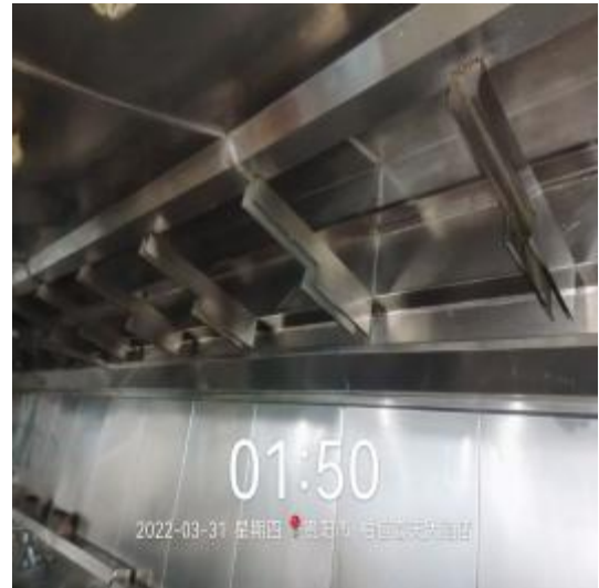
中厨房烟罩清洗中
