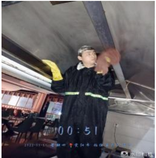
西厨房烟罩清洗中
