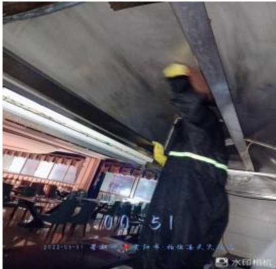
西厨房烟罩清洗中
