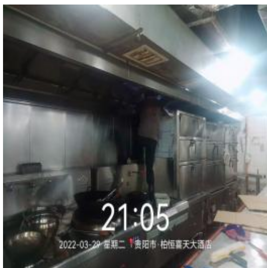
中厨房烟罩清洗中
