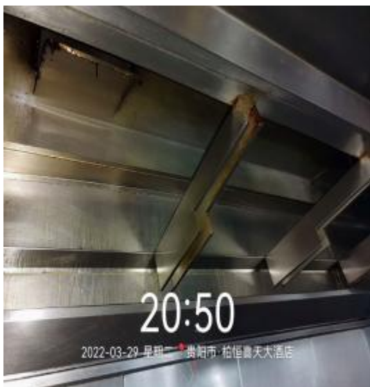
中厨房烟罩清洗中
